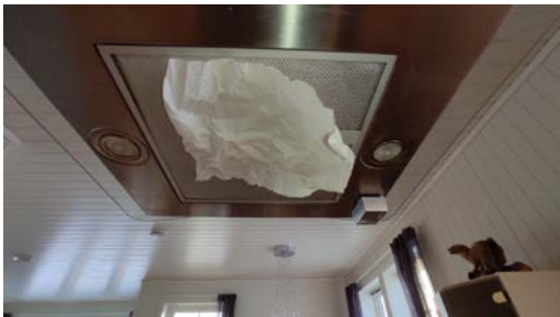
Test av avtrekket
