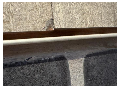
Tegn til fuktskade.
