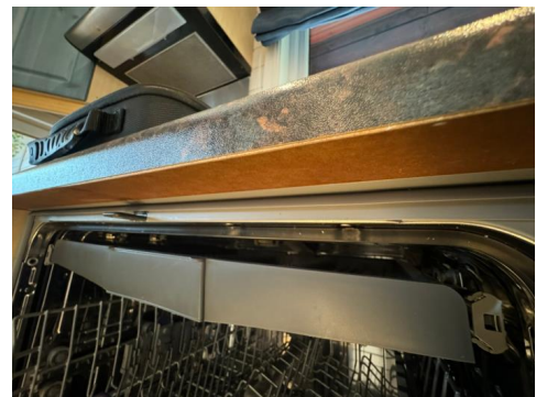
Svelling ved oppvaskmaskinen.
