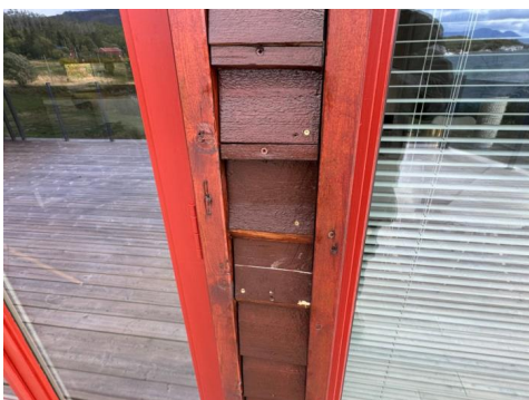
sprekker i kledningen.
