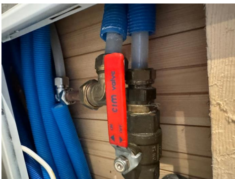
Eksempel på manglende tettemuffe.
