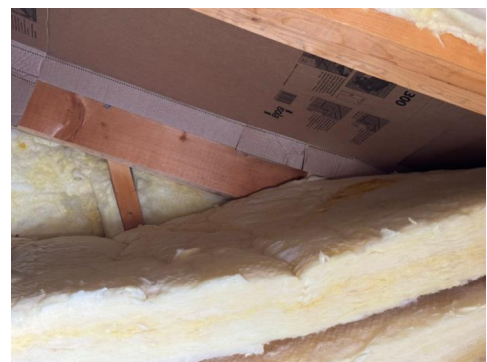
Isolasjon som har falt ned fra taket inne i knevegger.
