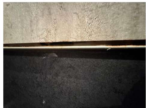
Dårlig fuget i nedkanten av baderomsplatene.
