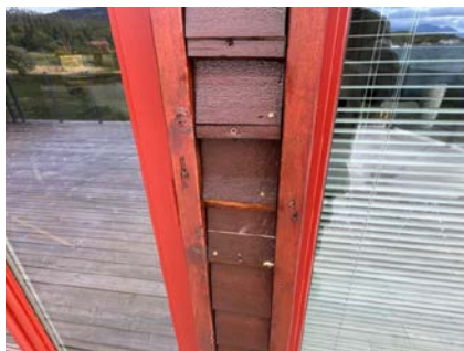
sprekker i kledningen.
