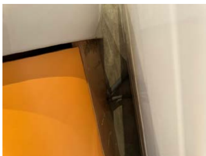
Skader på innredningen.
