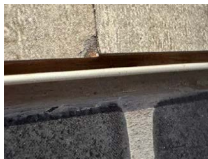
Tegn til fuktskade.
