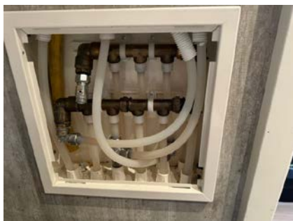
Rør i rør-skapet.
