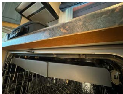
Svelling ved oppvaskmaskinen.
