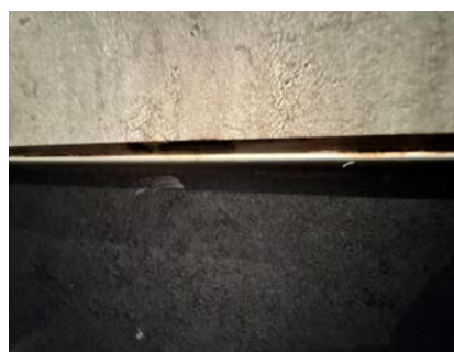
Dårlig fuget i nedkanten av baderomsplatene.
