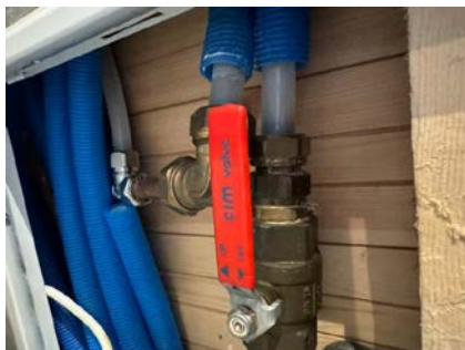
Eksempel på manglende tettemuffe.
