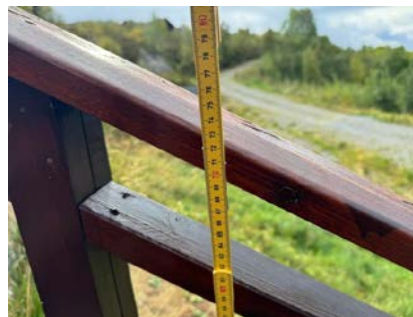
Rekkverkshøyde i trappen.
