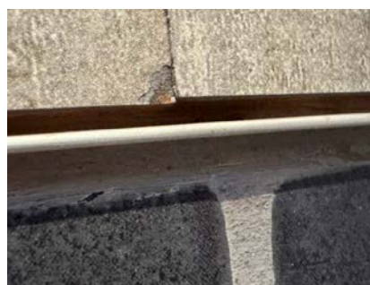
Tegn til fuktskade.
