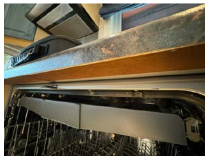
Svelling ved oppvaskmaskinen.
