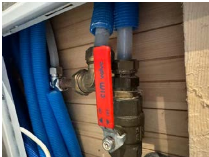
Eksempel på manglende tettemuffe.
