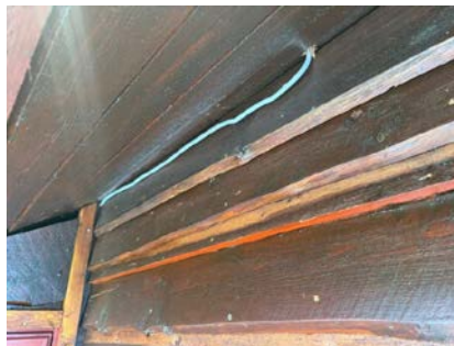
Eksempel på løs ledning.
