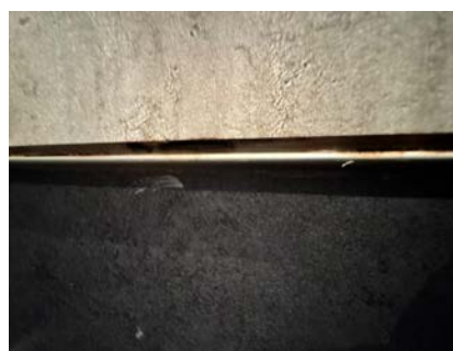
Dårlig fuget i nedkanten av baderomsplatene.
