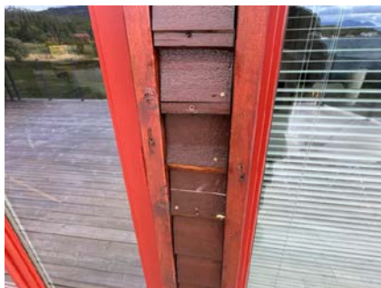
sprekker i kledningen.
