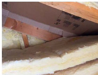
Isolasjon som har falt ned fra taket inne i knevegger.
