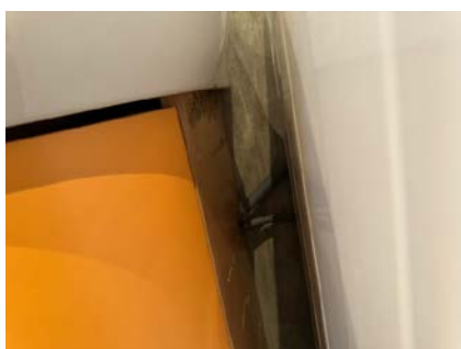
Skader på innredningen.
