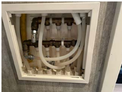
Rør i rør-skapet.
