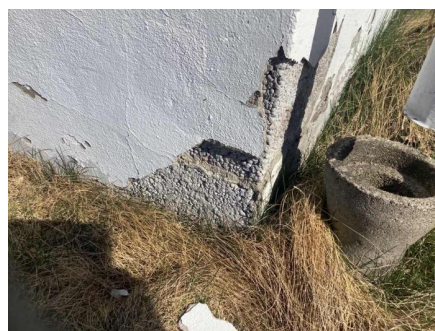
Avskaling på grunnmur på veranda.
