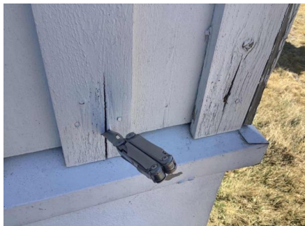
Eksempel på råte i kledningen.
