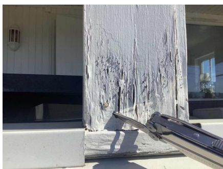
Råte i kledning rundt søyle.
