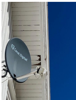
Mørkt området på takutstikket kan inneholde råte.
