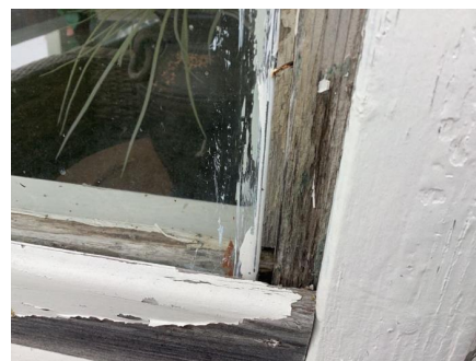
Vindu har løst glass.
