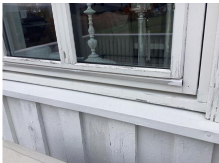
Eksempel på slitasje.
