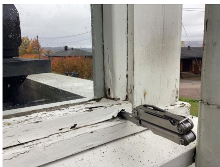
Råte i vindu mot nord.
