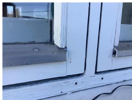
Eksempel på slitasje.
