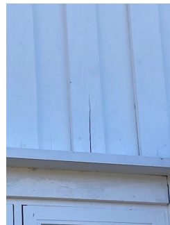
Eksempel på sprekk i fasadekledning.
