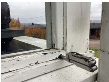
Råte i vindu mot nord.
