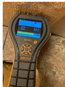
Fuktinnhold i treverk i kjeller på 19,7 vektprosent. Målt i 2023.
