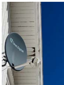
Mørkt området på takutstikket kan inneholde råte.
