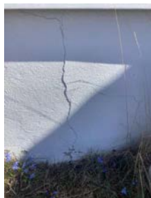
Eksempel på sprekk i grunnmur.
