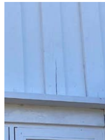
Eksempel på sprekk i fasadekledning.
