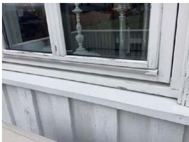
Eksempel på slitasje.
