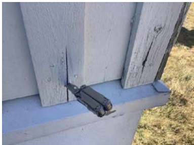
Eksempel på råte i kledningen.
