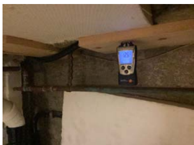
Fuktinnhold i treverk i kjeller på ca. 12 vektprosent. Målt i 2024.
