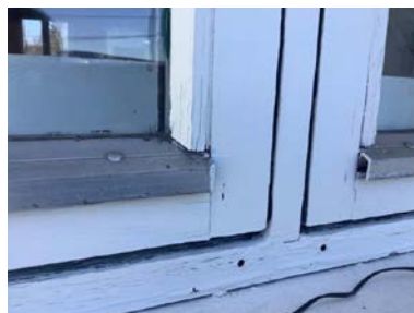
Eksempel på slitasje.
