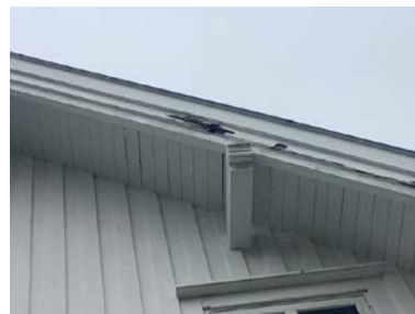
Bildet viser råte i vindski og muligens videre inni sperre.
