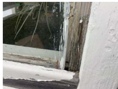
Vindu har løst glass.
