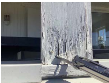
Råte i kledning rundt søyle.
