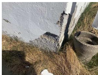
Avskaling på grunnmur på veranda.
