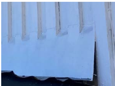
Bildet viser beslag over garasje som er spikret utenpå kledning.
