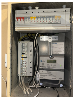
Sikringsskap med automatsikringer.
