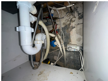
Rørøpplagg i kjøkkenbenk med Waterguard
