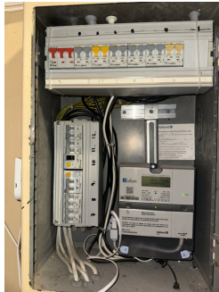
Sikringsskap med automatsikringer.
