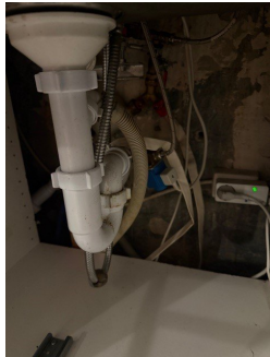
Røropplegg i kjøkkenbenk med Waterguard
