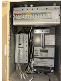
Sikringsskap med automatsikringer.
