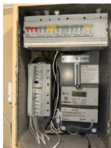
Sikringsskap med automatsikringer.
