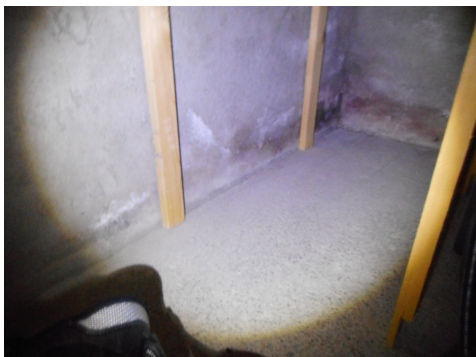
Litt saltutslag i bod. Det ble ikke målt fukt ved befarings.
