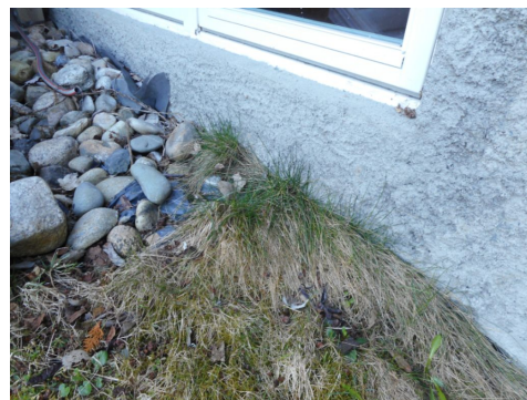
Grunnmursplast under bakkenivå.
