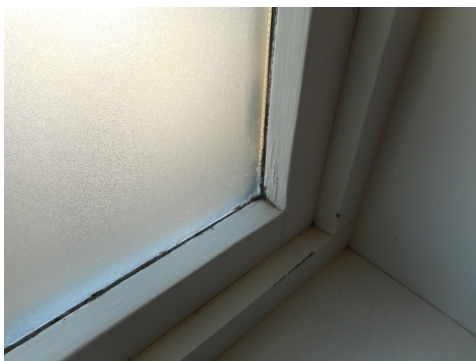
Fuktskader vindu bad 1 etasje.
