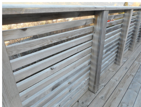
Stor åpning i liggende rekkverk.
