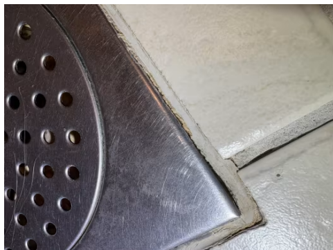
Sprekk i overgang gulv/sluk.
