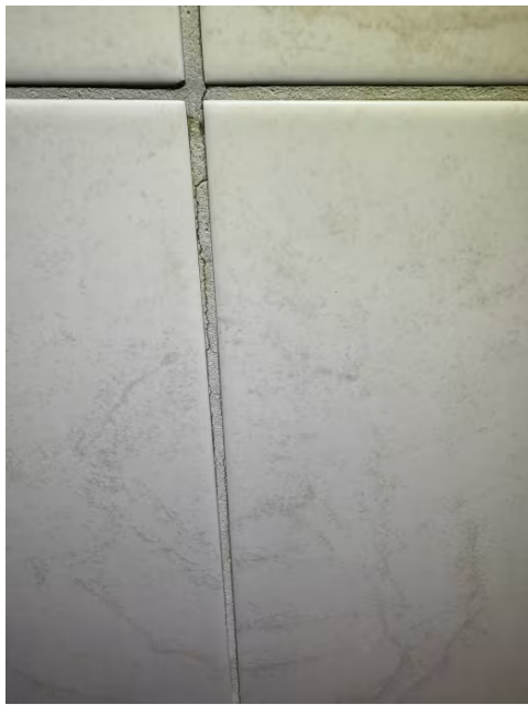
Sprekk i flisfuge på vegg i dusjnisje.
