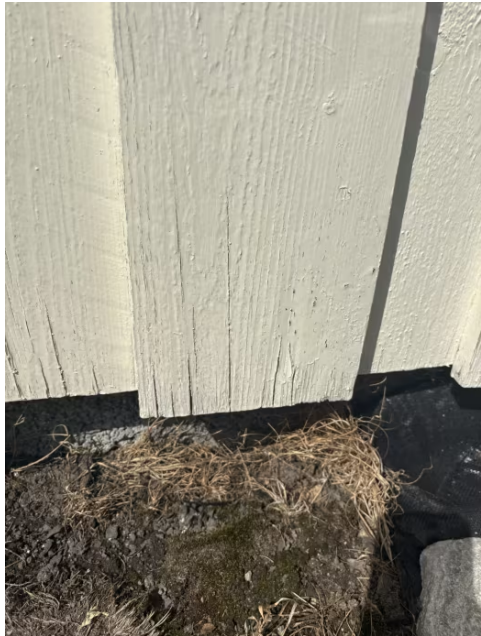
Sprekker i kledning.
