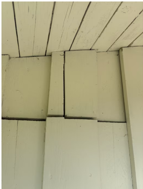
Sprekker i kledning.
