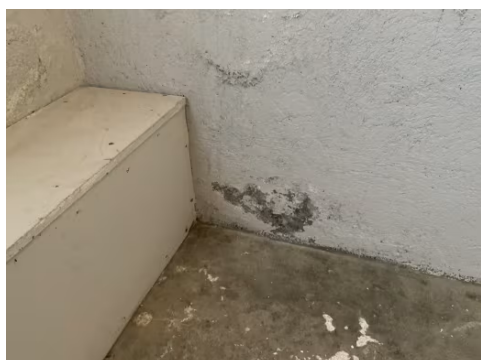
Saltutslag innvenig grunnmur.
