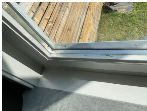
Avflasket maling innvendig vindu.
