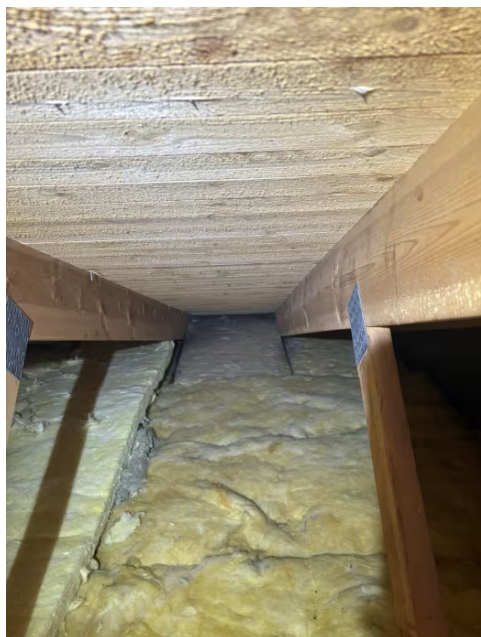
Redusert lufting i raftet.
