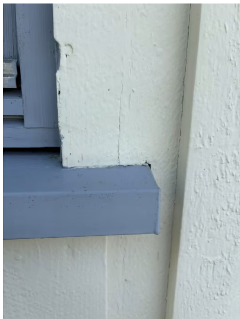
Panel ned til vannbrett.
