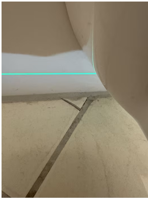
Løs flis under wc.
