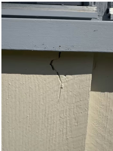
Sprekker i kledning.
