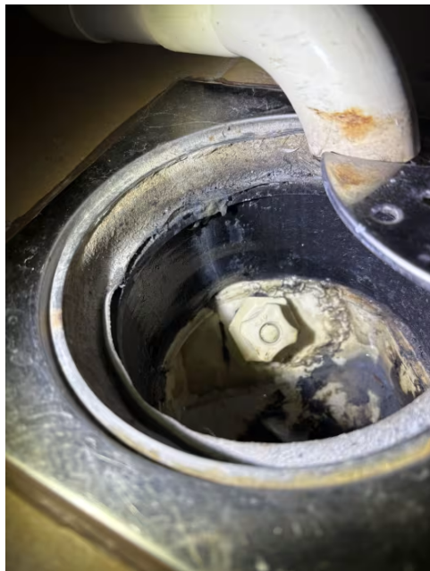
Feil utførelse på membra ved sluk.
