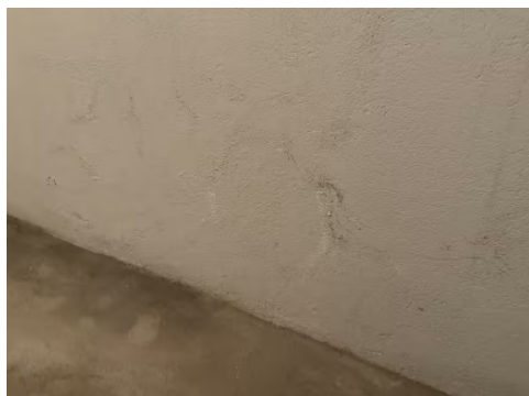
Saltutslag innvenig grunnmur.
