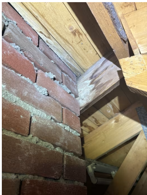
Fuktmerker rundt pipe.
