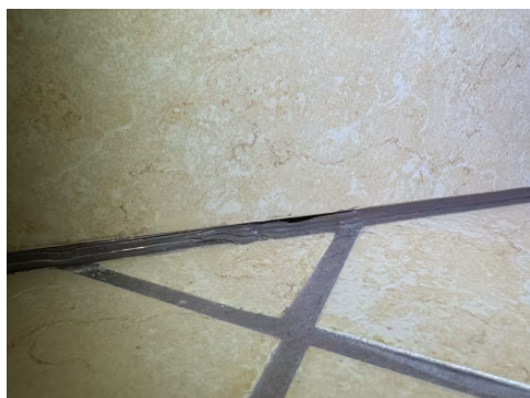
Sprekk mellom gulv og vegg.
