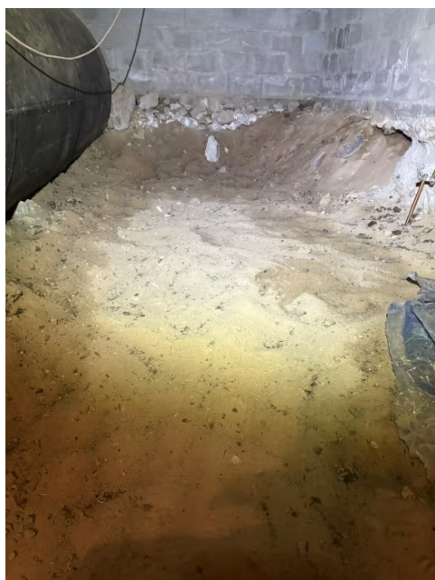
Fuktighet lang ytervegger.
