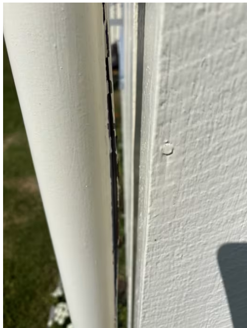
Frostsprengh i nedløpsrør.
