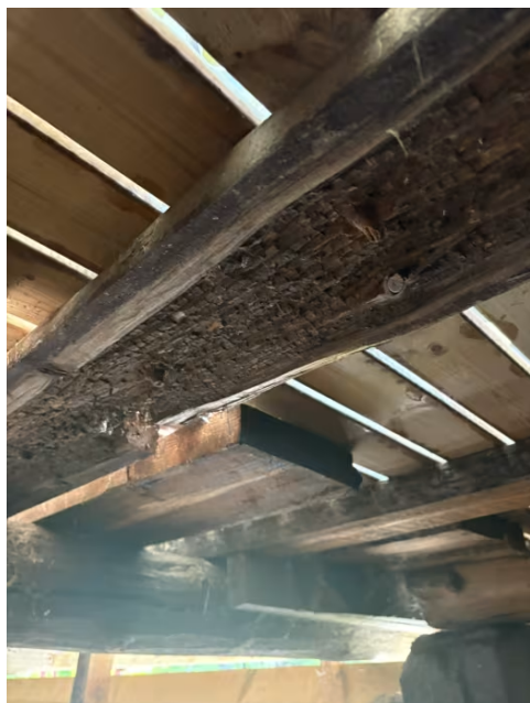
Råteskade i konstruksjonen.
