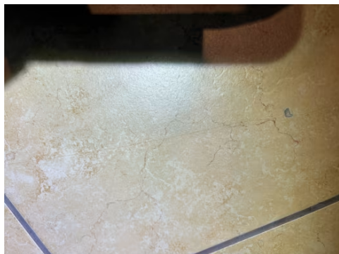
Sprekk i flis.
