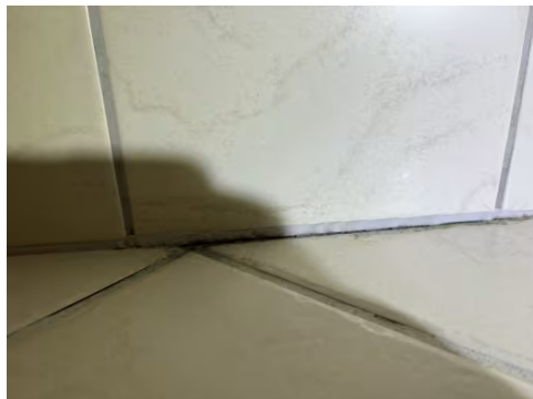
Sprekk i overgang gulv/vegg.
