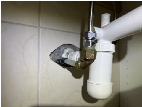
Manglende tetting på gjennomføring i vegg.
