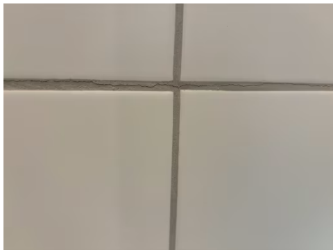
Sprekk i kasse til wc
