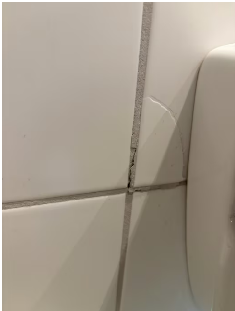
Sprekk i kasse til wc
