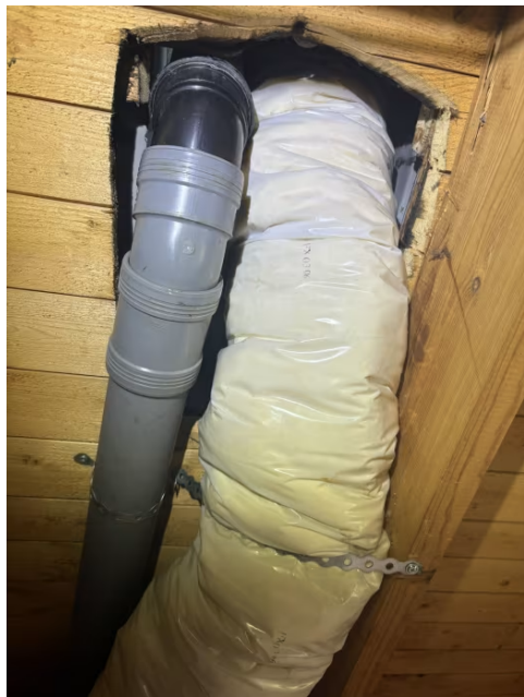
Lufting til avløpsrør.
