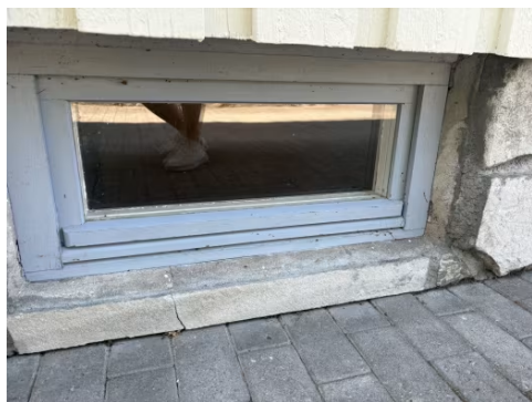
Sprekk i grunnmur.
