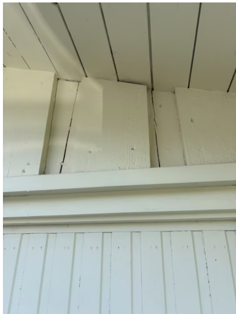
Sprekker i kledning.
