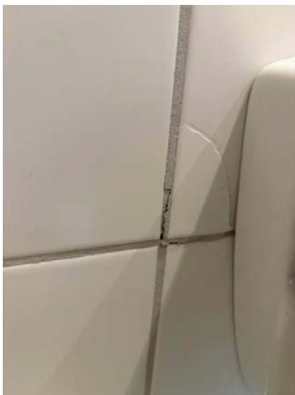
Sprekk i kasse til wc
