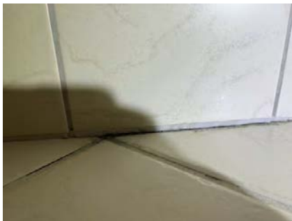
Sprekk i overgang gulv/vegg.
