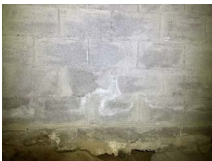
Saltutslag på yttervegger.
