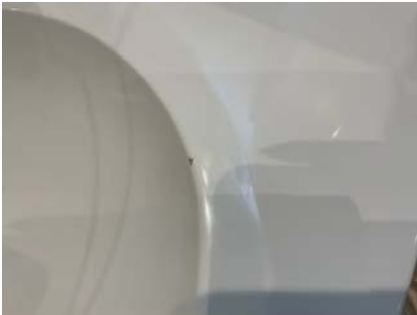
Avskalling på servant.
