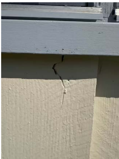
Sprekker i kledning.
