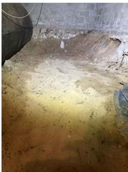
Fuktighet lang ytervegger.
