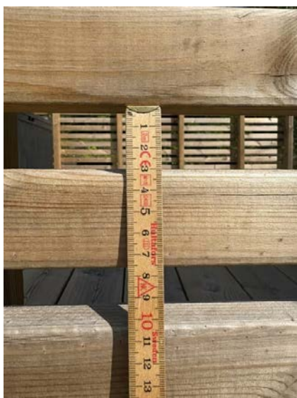
Avstand mellom liggende spiler på terrasse.
