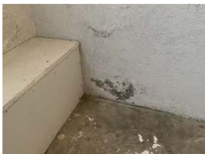
Saltutslag innvenig grunnmur.
