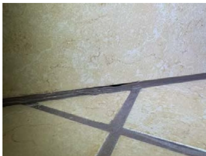
Sprekk mellom gulv og vegg.
