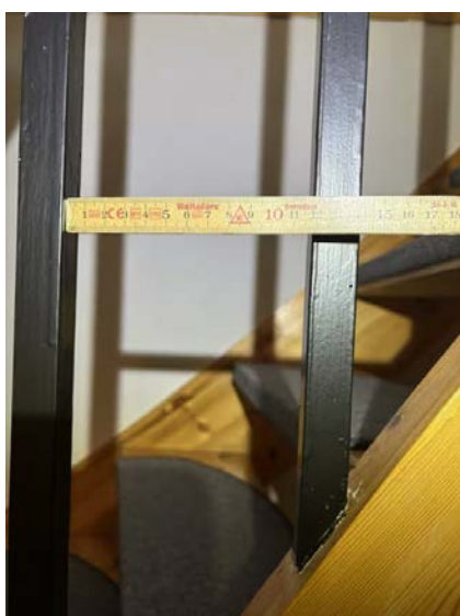
Åpninger i rekkverk.
