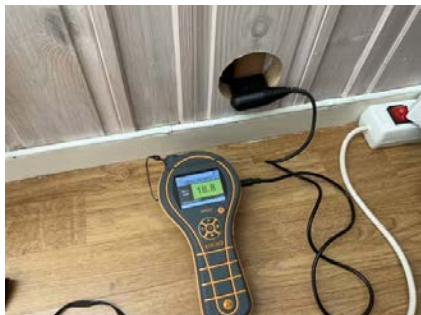
Fuktmåling i vegg mot terreng.
