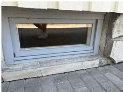
Sprekk i grunnmur.
