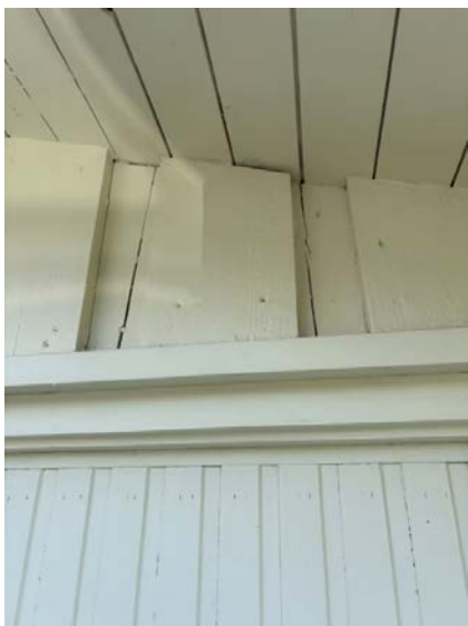
Sprekker i kledning.
