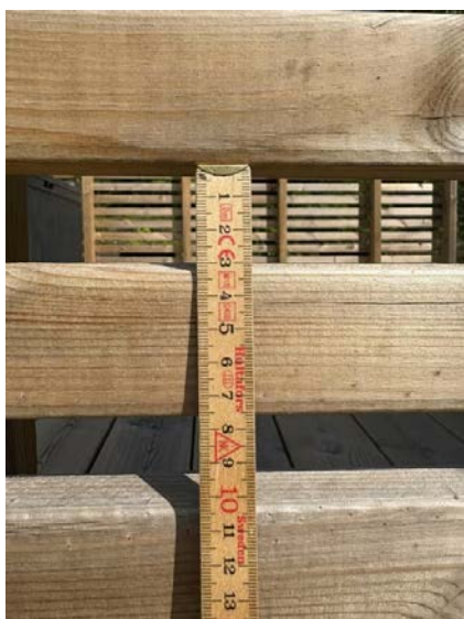
Avstand mellom liggende spiler på terrasse.
