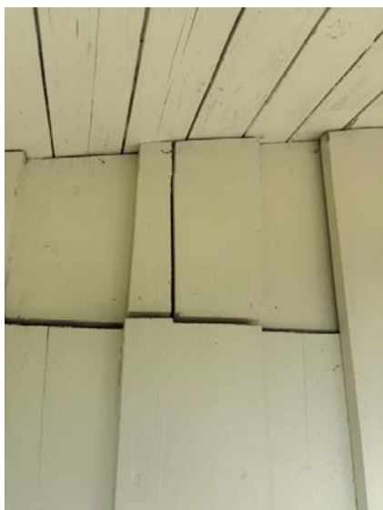
Sprekker i kledning.
