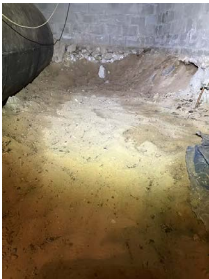
Fuktighet lang ytervegger.
