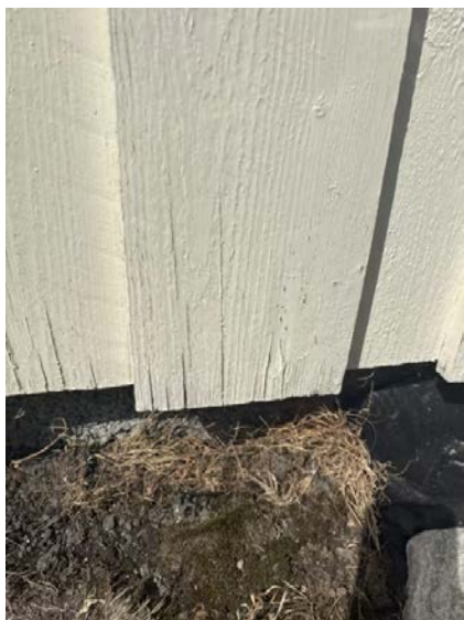
Sprekker i kledning.
