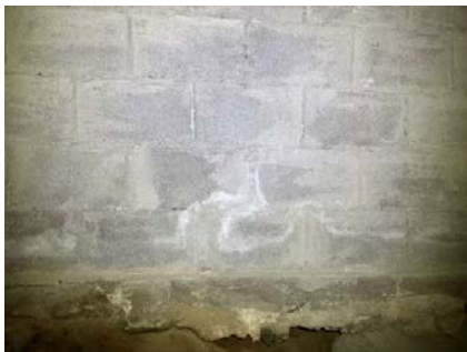
Saltutslag på yttervegger.
