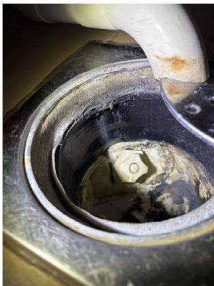
Feil utførelse på membra ved sluk.
