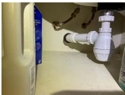
Avløpsrør bad kjeller.
