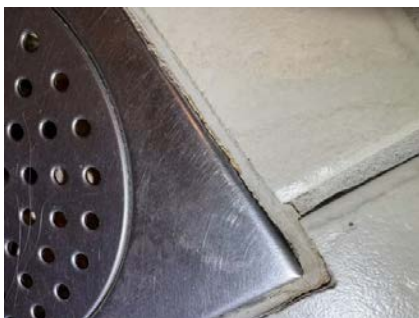
Sprekk i overgang gulv/sluk.
