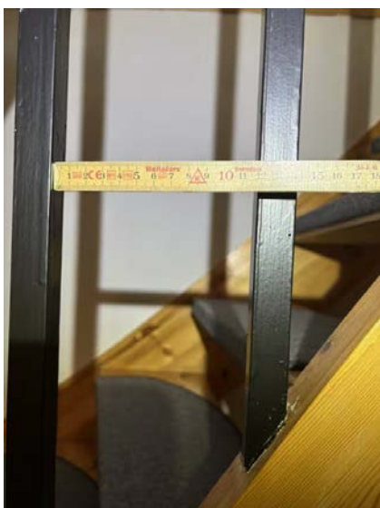
Åpninger i rekkverk.
