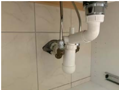
Avløpsrør bad 1. etg
