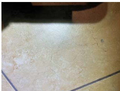
Sprekk i flis.
