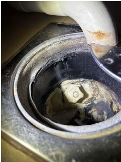
Feil utførelse på membra ved sluk.
