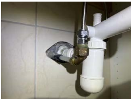
Manglende tetting på gjennomføring i vegg.
