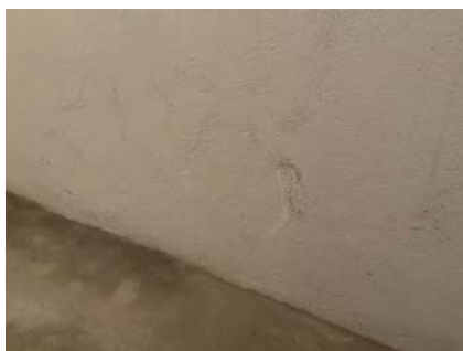
Saltutslag innvenig grunnmur.
