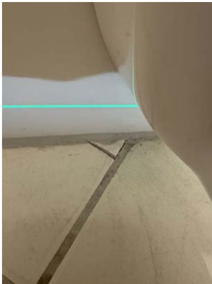
Løs flis under wc.
