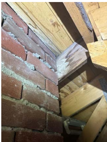
Fuktmerker rundt pipe.
