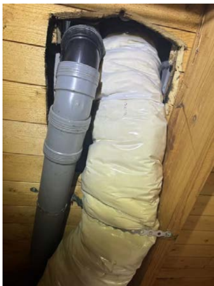
Lufting til avløpsrør.
