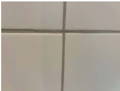
Sprekk i kasse til wc
