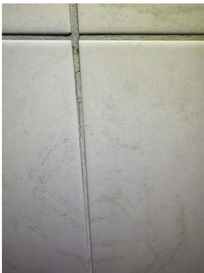
Sprekk i flisfuge på vegg i dusjnische.
