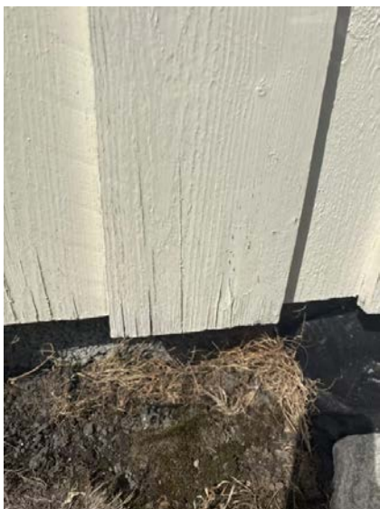
Sprekker i kledning.
