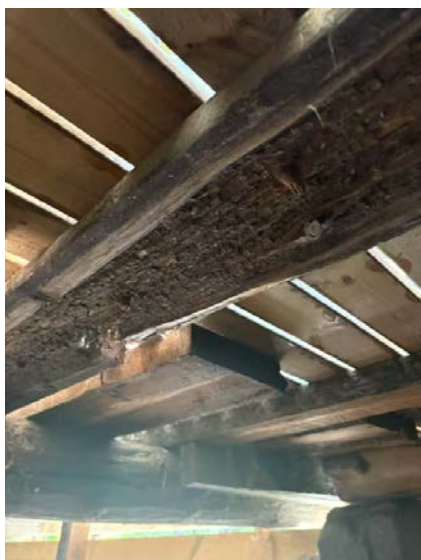
Råteskade i konstruksjonen.
