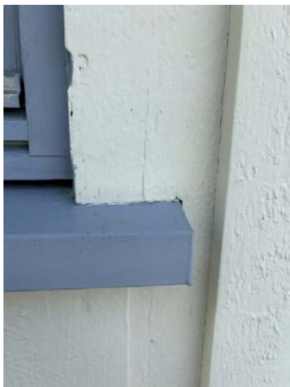
Panel ned til vannbrett.
