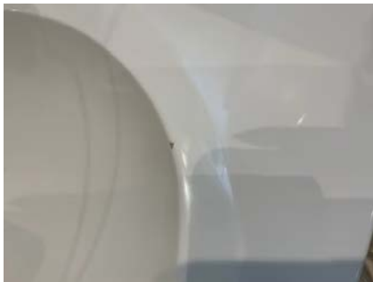
Avskalling på servant.
