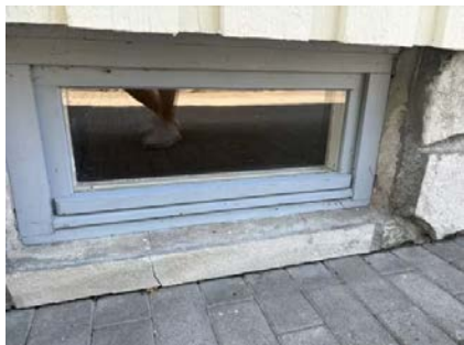
Sprekk i grunnmur.
