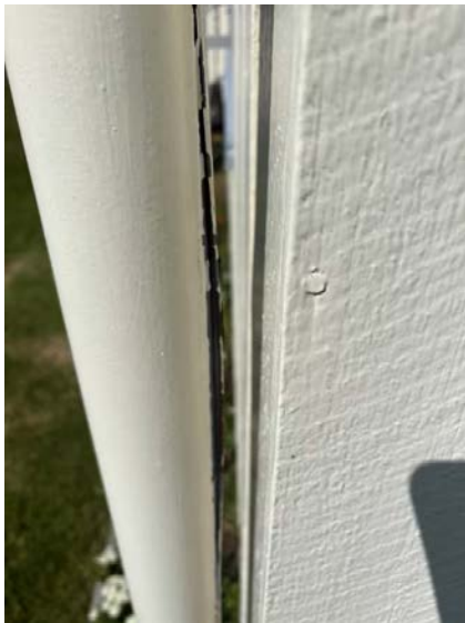
Frostsprengh i nedløpsrør.
