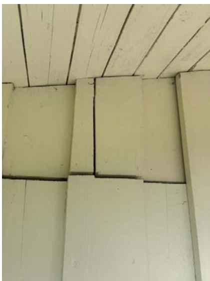
Sprekker i kledning.
