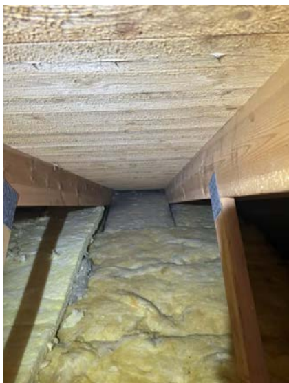
Redusert lufting i raftet.
