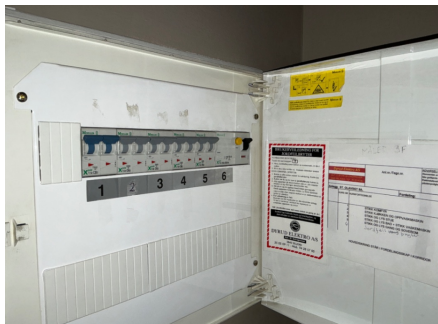
Automatsikringer i sikringsskap plassert i entre.
