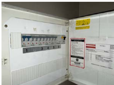
Automatsikringer i sikringssskap plassert i entre.
