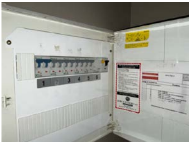
Automatsikringer i sikringsskap plassert i entre.
