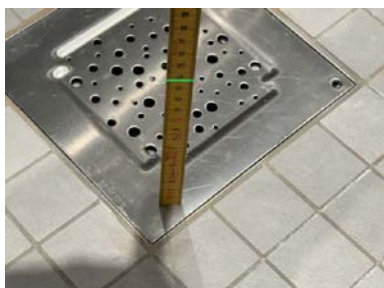
Fallforhold ca. 138 mm topp slukrist i dusjsone
