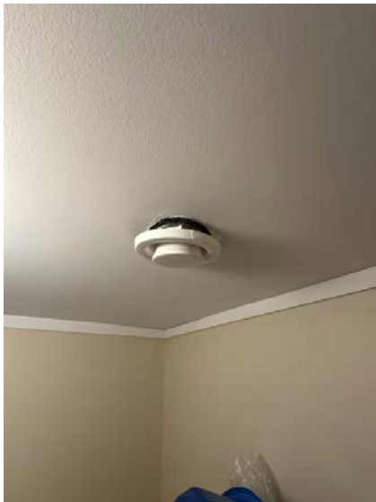
Ventil i himling er løs.
