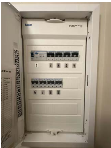
Viser sikringsskap plassert i bod.
