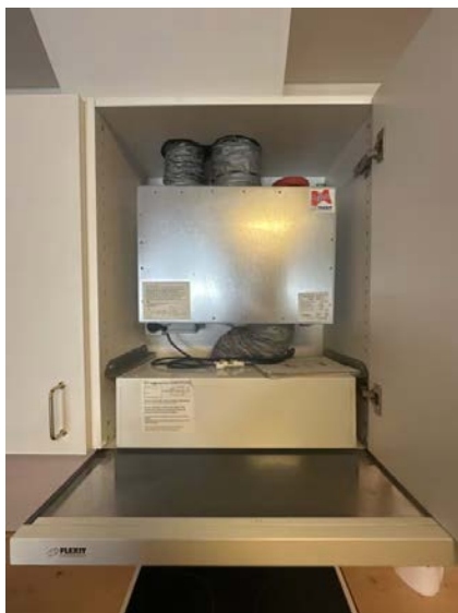
Ventilator tilknyttet sentralavtrekk.
