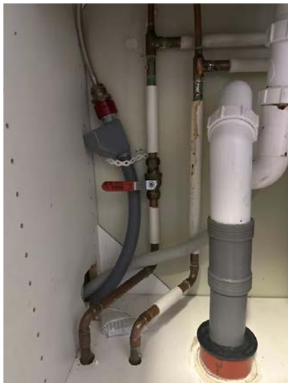
Hovedstoppekran for kjøkkenet er plassert under oppvaskkum.
