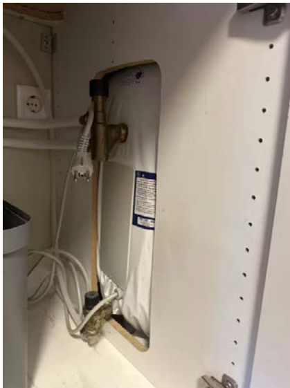
Viser bereder plassert i hjørneskap på kjøkkenet.
