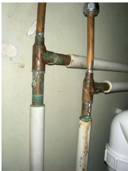
Det registreres irr på rør og koblinger.
