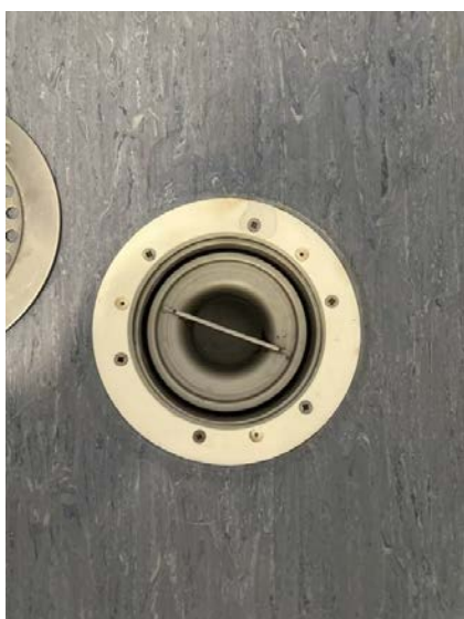
Viser sluk i dusjsonen.
