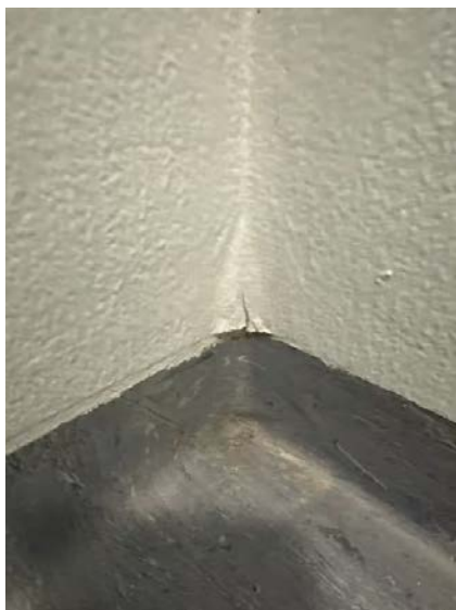
Det registreres svelling i tapet.
