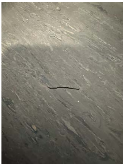
Det registreres sprekk i belegg i dusjsone.
