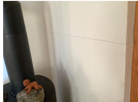
Sprekk i brannmur.
