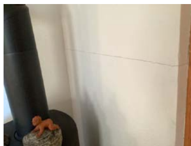
Sprekk i brannmur.
