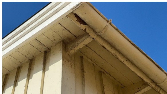
Eksempel på slitasje.
