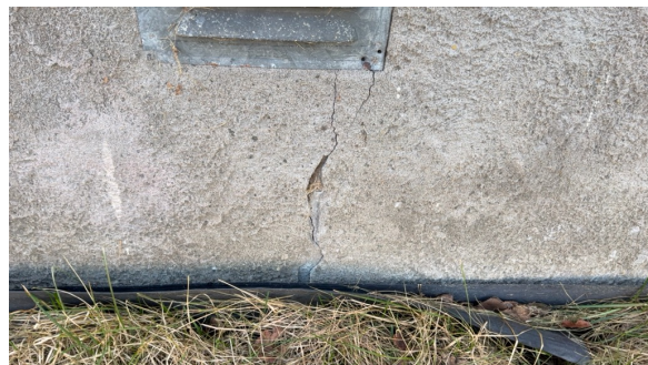
Det er stedvis sprekker i grunnmur.
