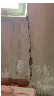
Det er stedvis sprekker i grunnmur.
