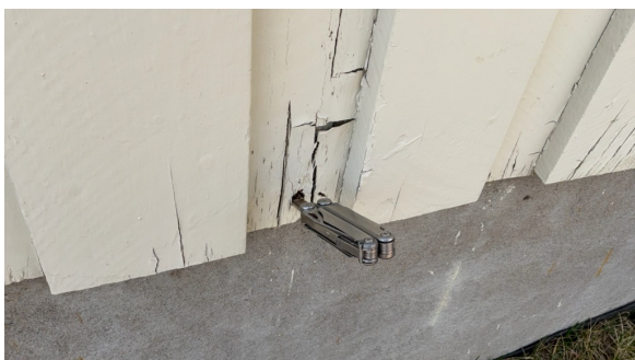
Eksempel på råte i kledning.
