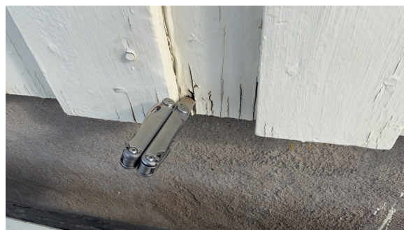
Eksempel på råte i kledning.
