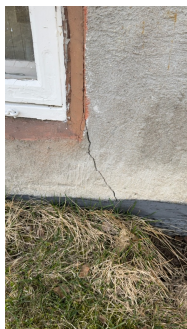
Det er stedvis sprekker i grunnmur.
