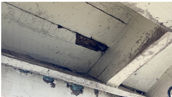
Det er råte i kledning i takutstikk ved entre.
