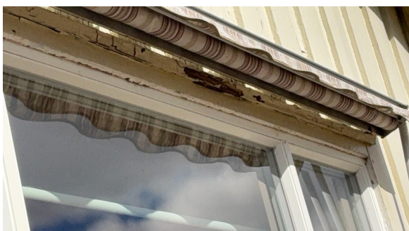
Eksempel på råte i kledning.
