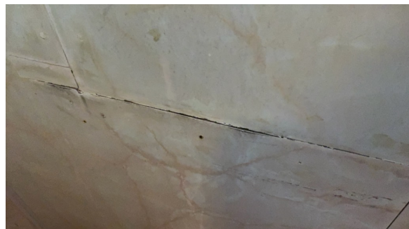
Skjøter på veggplater i våtsone.
