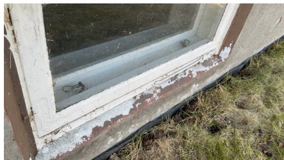
Eksempel på slitasje.
