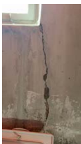
Det er stedvis sprekker i grunnmur.
