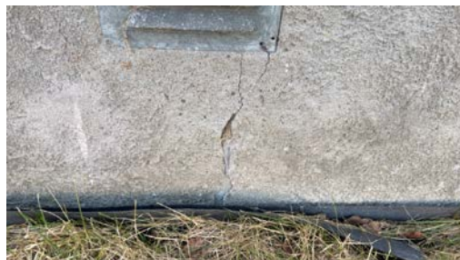
Det er stedvis sprekker i grunnmur.
