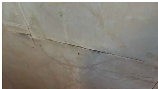
Skjøter på veggplater i våtsone.
