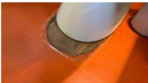
Utett i gulv ved toalett.
