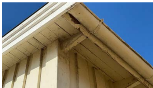
Eksempel på slitasje.
