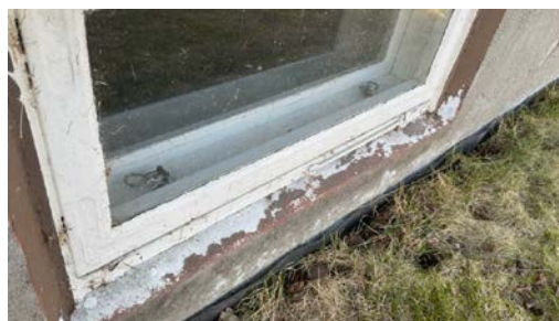
Eksempel på slitasje.
