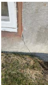
Det er stedvis sprekker i grunnmur.
