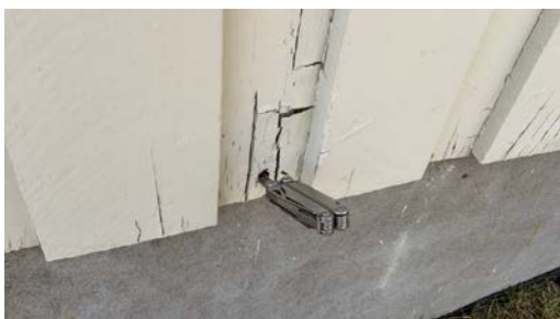
Eksempel på råte i kledning.
