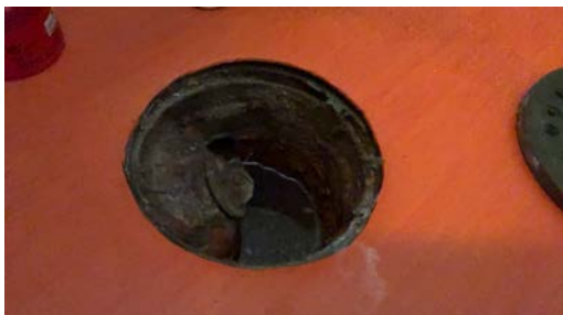
Det er ikke tilslutning mellom gulvbelegg og sluk.
