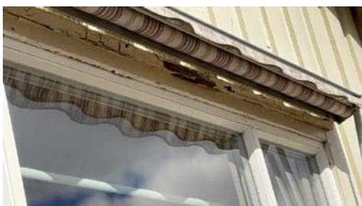
Eksempel på råte i kledning.
