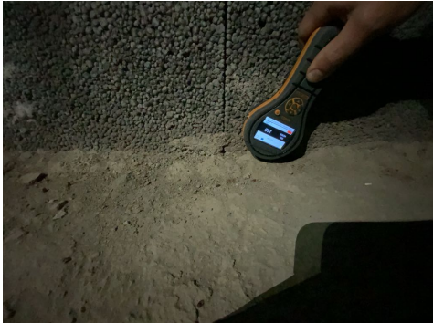
Indikert variable fuktverdier på nedre del av grunnmur.
