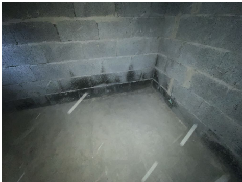
Synlige fuktflekker på nedre del av grunnmur.
