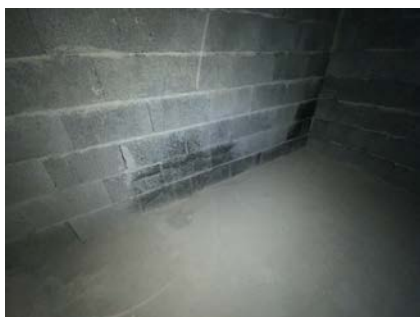
Synlige fuktflekker på nedre del av grunnmur.
