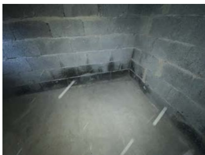
Synlige fuktflekker på nedre del av grunnmur.
