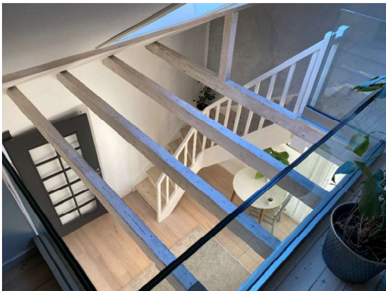
Figur 4: Bildet viser det eksponerte bjelkelaget ved trappen opp til loftet. Her ser vi at kneveggene er flyttet og redusert til kun en stoppe ned på bjelken nærmest trappen. I tillegg er bunnsvillen som skal fordele lastene utover bjelkelaget fjernet. Veggene var tidligere på linje med veggene vi ser hjørnet av nederst til venstre i bildet.
