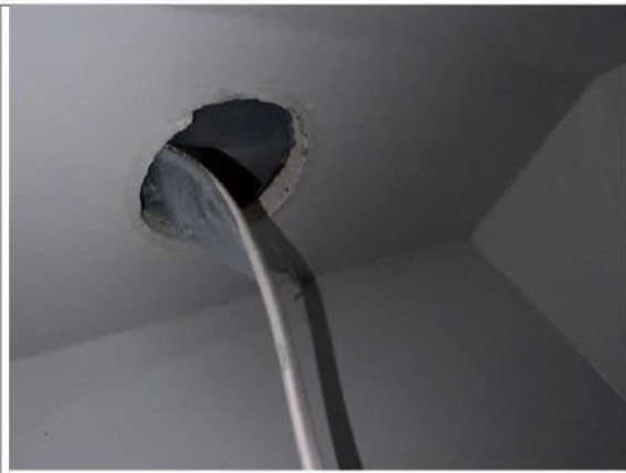
Brudd i dampsperre.
