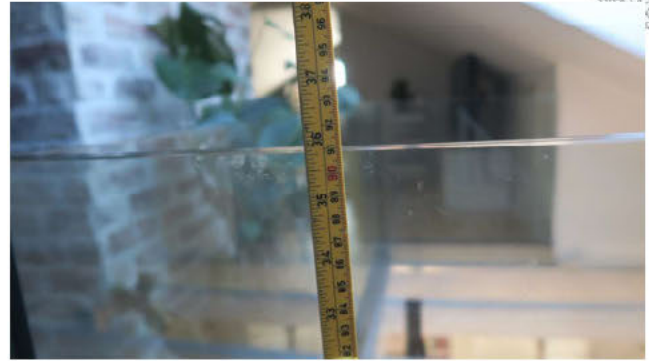
Rekkverk er ikke i tråd med krav i TEK17 §12-15, 3. ledd og må skiftes eller heves. Grunnet endringer ved trappeløp vil det ikke være mulig å beholde dagens rekkverk.
