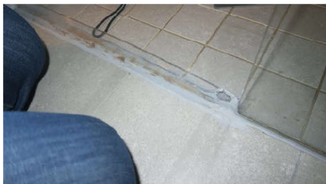
Plastlist hindrer eventuelt lekkasjevann i å evakuere til sluk.
