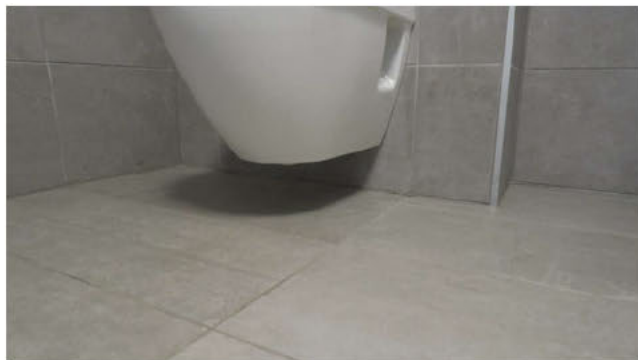
Drenshull mangler på toalett.
