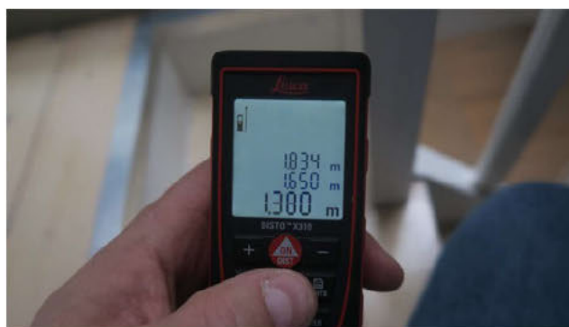
Her er det kun 138 cm fri høyde. Ved flytting av trapp må høyde økes med 62 cm i tillegg til at taket må senkes med 10 cm. Totalt må ny trapp gi 72 cm bedre takhøyde. Dette gir 4 ekstra trinn.
