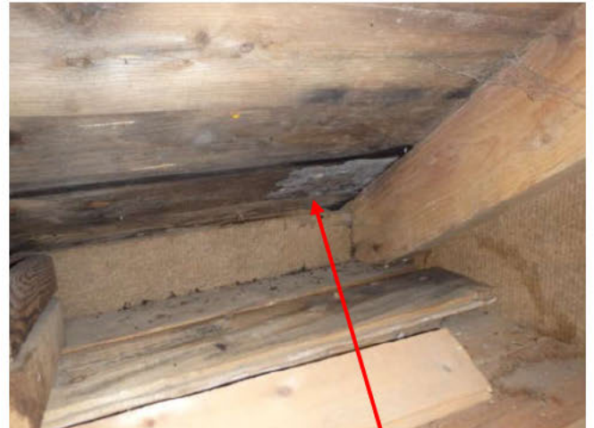
Bilde nr. 16 Kneloft mot øst. Ingen luftespalter ved raft / overgang tak og yttervegg. Synlig svartesopp og missfarging i undertak.
