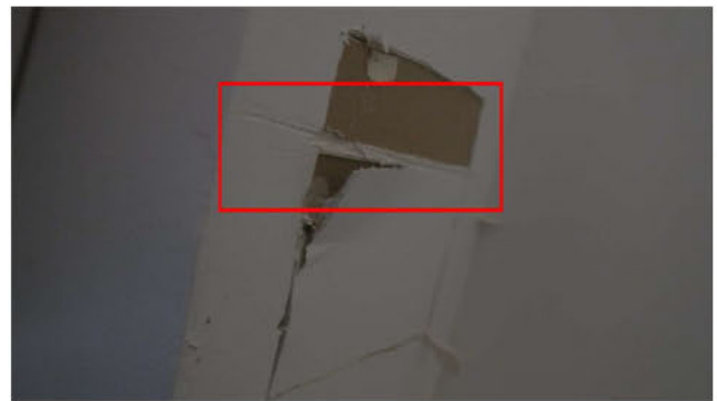
Man ser tydelig at det tidligere er skåret opp i kassen. Dette er fuget og malt over.
