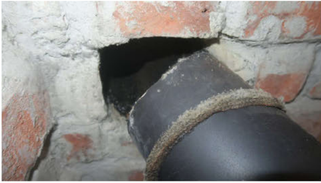
Løst røykrør inn i pipe må festes.
