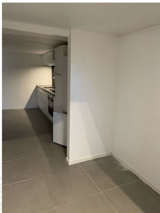
Vegg i kjeller der grunnmur av leca er ca 7 meter. Maks spenn i Leca sine anvisninger er 6 meter uten andre tiltak.
