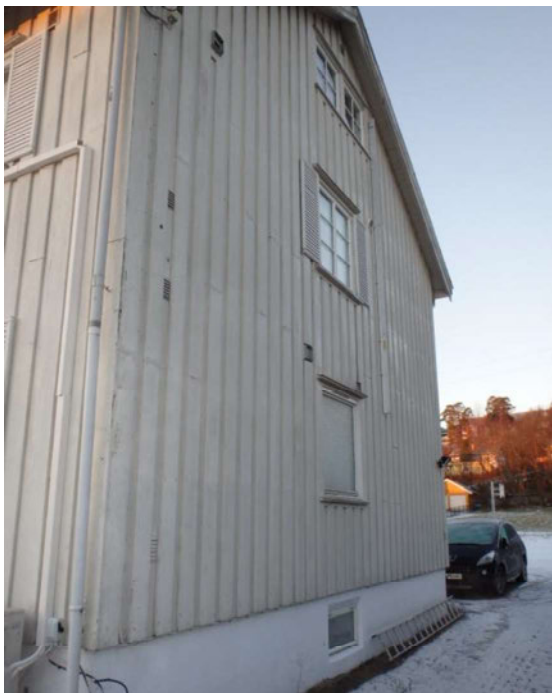
Bilde nr. 9 Fasade mot nord. Brannstige vil komme nærmere enn 2 meter for vinduer.
