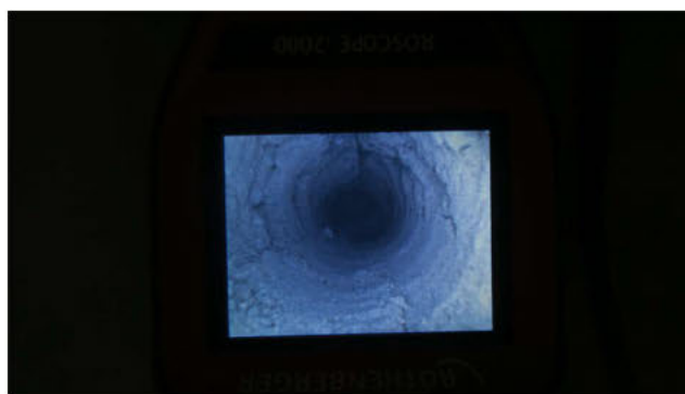
Ingen tegn til isoblokk her heller. På tre steder er det ikke avdekket tegn til isoblokk, som forutsatt i søknad fra 1997.
