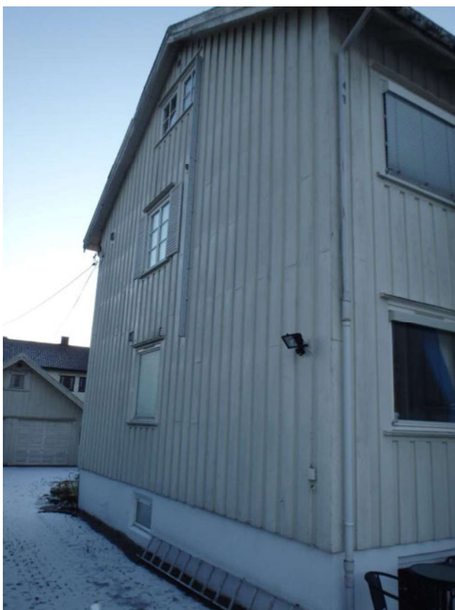
Bilde nr. 7 Fasade mot nord. Brannstige vil komme nærmere enn 2 meter for vinduer.
