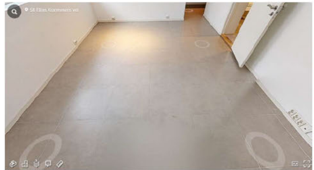
Flislagt gulv med omfattende bom i fliser. Må skiftes for å utbedre. Vurderes under punkt for el-arbeider.
