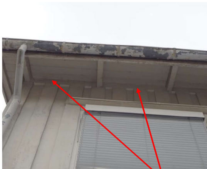
Bilde nr. 24 Utvendig raft ved soverom Nord / Vest. Ingen lufting ved raft. Kneloft bak har mangelfull lufting.
