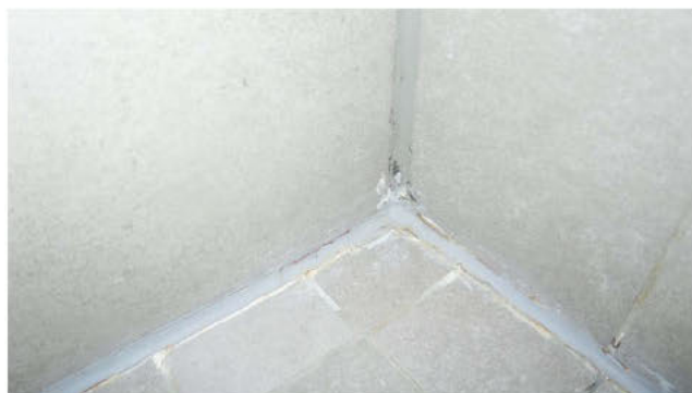
Fuger er ufagmessig utført.
