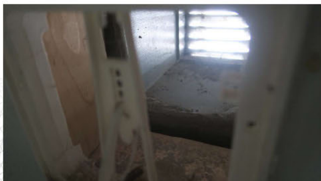
Godt synlig og uheldig løsning i veggventil med tanke på kondens og fuktskader i påført vegg.
