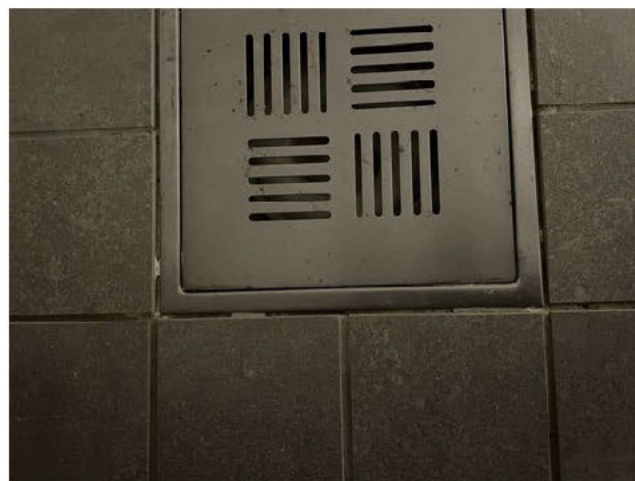
Fuger sprekker på bad.
