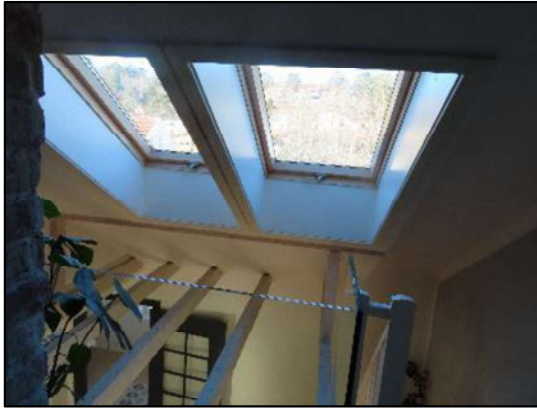
Knevegger er fjernet. Dog antas at taksperrer er forsterket i området rundt takvinduer. Toppsvill er intakt og eventuelt remontering av stolper er en enkel operasjon.
