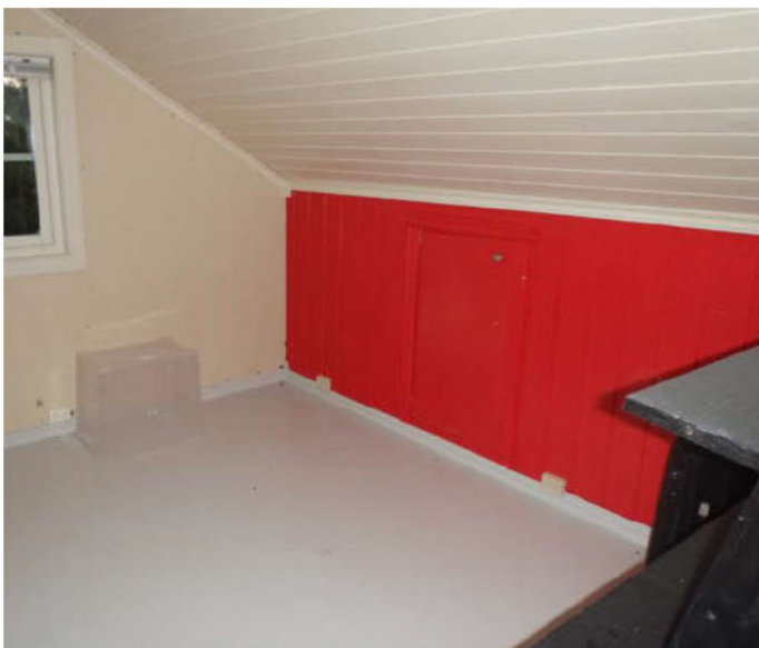
Bilde nr. 23 Soverom mot nord. Mangelfull lufting av skråhimling begge sider.
