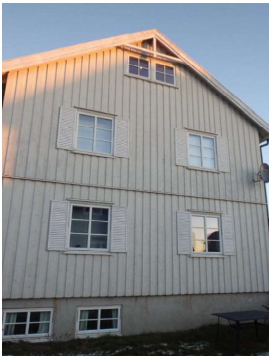
Bilde nr. 11 Fasade mot Syd. Hvis alternativt montere brannstige med ryggbøyle i denne gavel, må vinduer i 1. og 2. etg. skiftes til brannvinduer. Rommene her er soverom.
