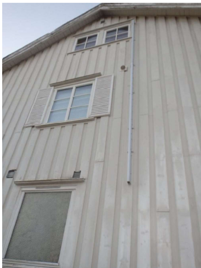
Bilde nr. 8 Fasade mot nord. Vindu i 1. etg og 2. etg. er vinduer til badetrom. Disse må og kan lett skiftes ut til brannvinduer.
