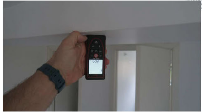
Drager tvers over stue har fri høyde på 1920 mm. Fare for å skalle i denne ved vanlig gange.
