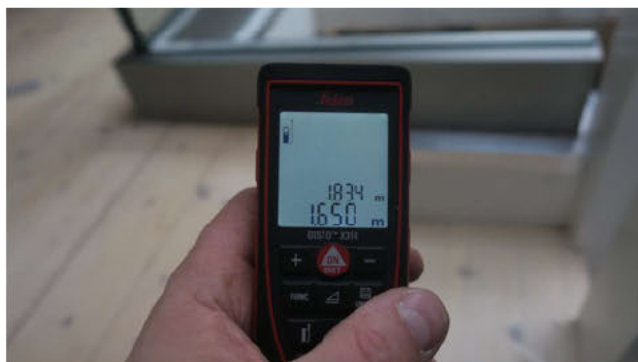
165 cm fra trinn til himling. Krav er minst 200 cm. 35 cm mangler i dag, selv uten isolering i himling.
