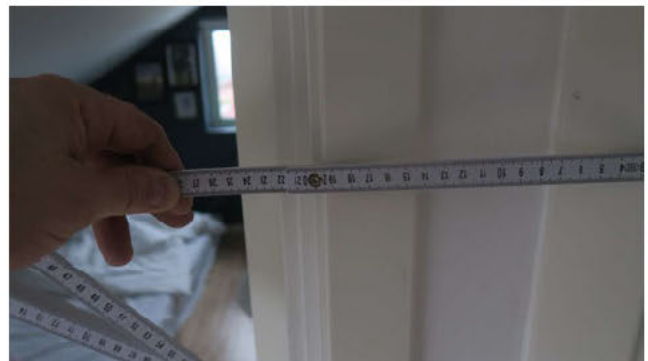
Bredde på dører kan ikke endres uten vesentlig ombygging av rom. Prosjektering av dette er ikke utført.
