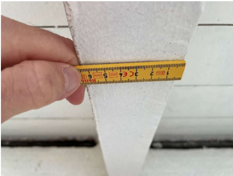
Figur 6: Bildet viser at taksperrere har en bredde på ca 65mm.
