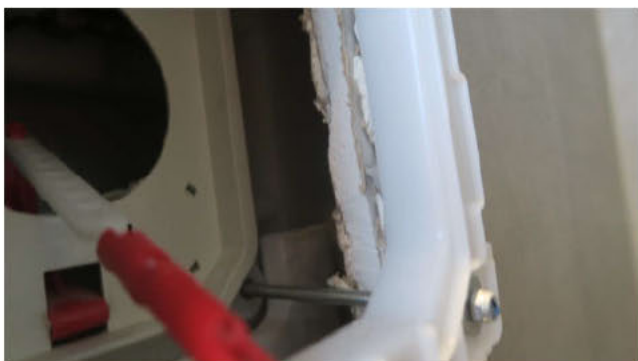
Det er eksponert gips i toalett-kassen bak flisene. Kassen er ikke bygget vannskadesikker.
