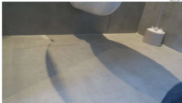
Bad 2. etasje ingen drenshull på toalett.
