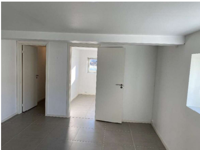
Figur 17: Bildet viser kjelleren hvor vi ser utvekslingsbjelken som er kasset inn oppe i bildet.
