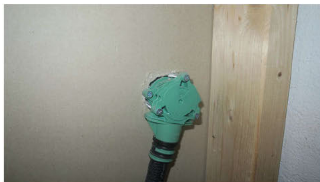
Innfesting av rør er ufagmessig utført.
