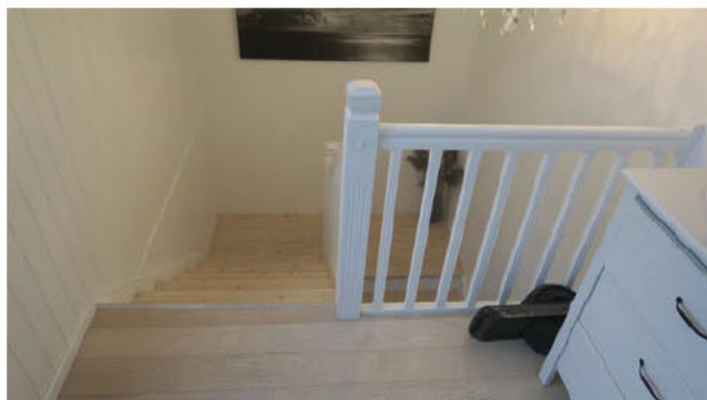
For å få en lovlig trappeforbindelse fra kjeller til 2. etasje må trappen skiftes.
