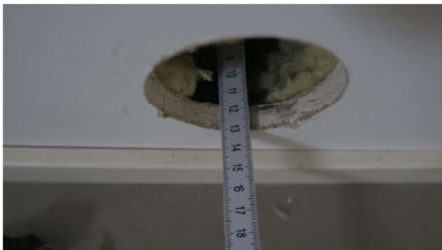
Måling fra eksisterende blindlokk i påforet vegg. Det er ca 11,5 cm fra bakside gips til grunnmur bak.
