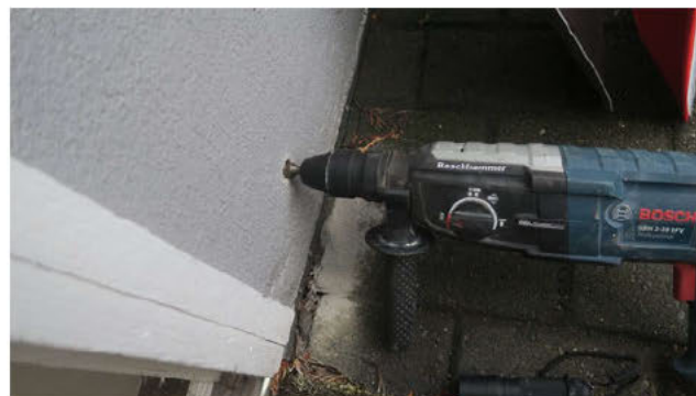
Det ble boret mer enn 20 cm inn i vegg.
