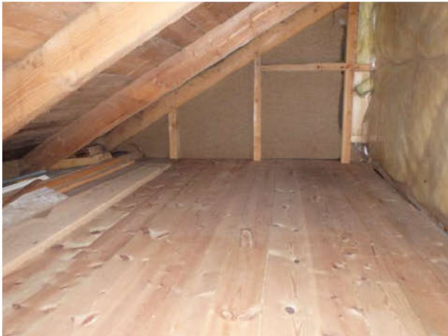
Bilde nr. 15 Kneloft mot øst. Ingen luftespalter i gavelvegger og ingen luftespalter ved raft / overgang tak og yttervegg.
