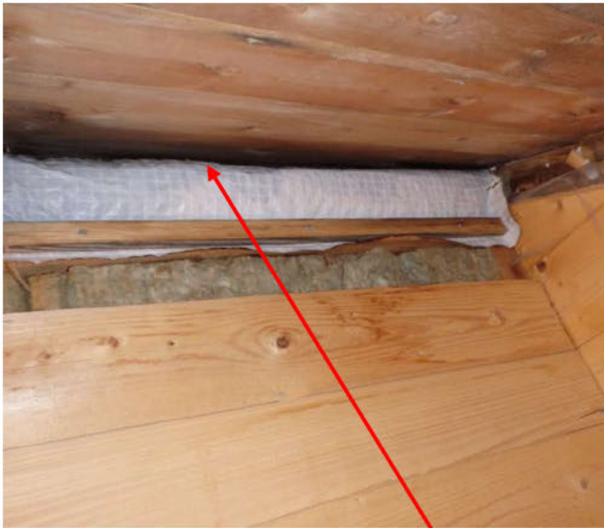
Bilde nr. 17 Himling over soverom nord. Fra kneloft. Luftespalte er for liten. Tilstrekkelig luftgjennomstrømning lar seg ikke oppnå.
