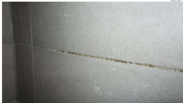
Fuger er ufagmessig utført.
