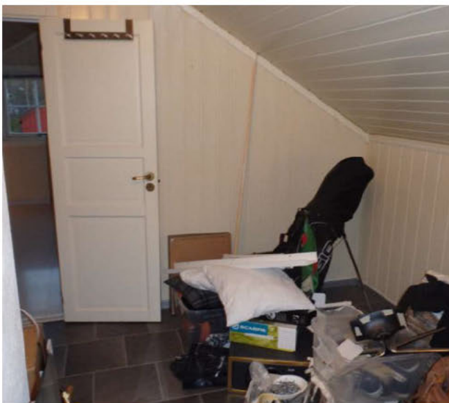
Bilde nr. 21 Rom ved trapp. Trepanel i himling. Her er mangelfull luftespalte i skråhimling.
