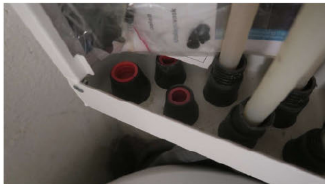
På befaring ble det avdekket manglende dremsmulighet fra skapet. Akkurat dette er enkelt å løse, men vitner om ufagmessighet og manglende kunnskaper om faget. Lekkasjevann skal ledes til rom med sluk eller så skal vannet automatisk stenges.
