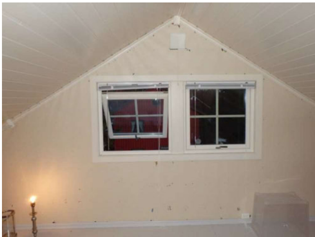
Bilde nr. 1 Soverom 3. etg. mot Nord. Vinduer har brystningshøyde 85 cm.
