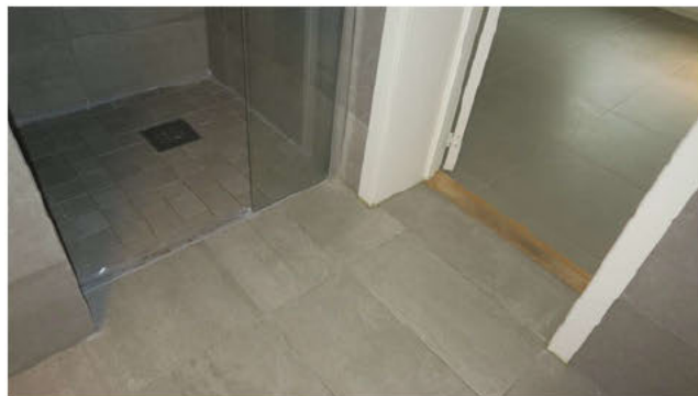
Vann vil ledes ut av rommet og ikke til sluk. Dokumentasjon på badet er ikke fremlagt.
