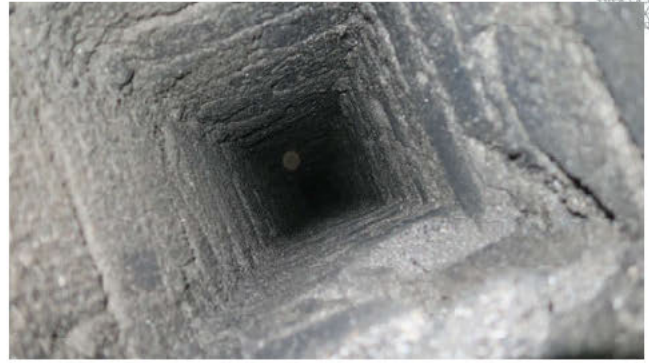
Innvendig pipeløp må rehabiliteres basert på tilsynet fra brannvesenet.
