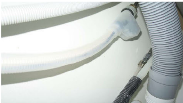
Bilde fra FBTs befaring av skapet. Ingen endemuffer på rør-i-rør.
