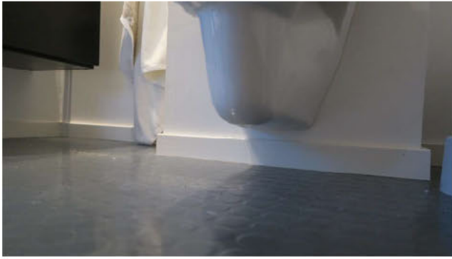
Ingen drenshull til WC. Dette er ikke beskrevet i tilstandsrapport.
