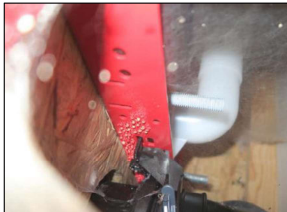
Fukt/kondens inne i siternekasse
