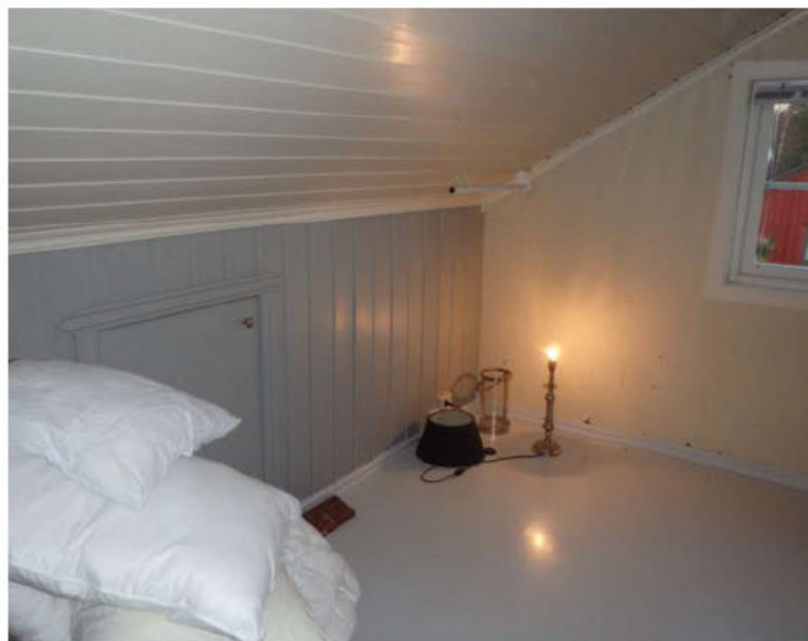
Bilde nr. 22 Soverom mot nord. Mangelfull lufting av isolert skråhimling.
