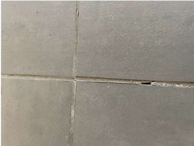
Fuger sprekker på andre gulv i kjeller. Fliser er løse og kan trykkes opp og ned.
