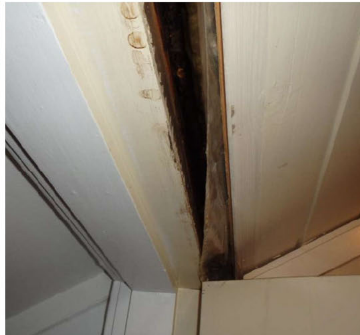
Bilde nr. 20 Dør inn til gang på loft / 3. etasje. Fukt / kondensvann har rent ut i overkant av dørkarm.
