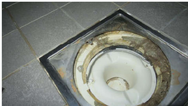
Mansjett er ikke smurt under klemring og trekker fukt som kan medføre skader.
