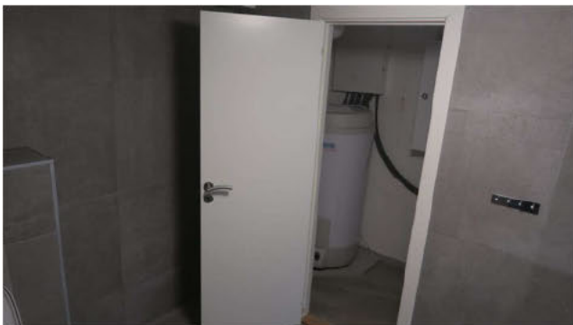
Dør til teknisk rom.
