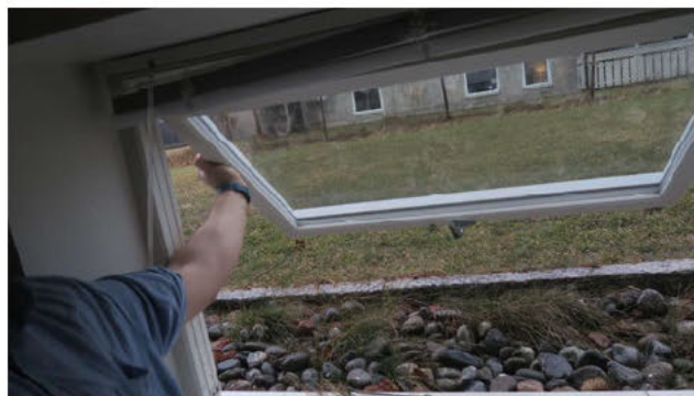
Topphengslet vindu gjør det vanskeligere å bruke vinduet til rømningsvei.
