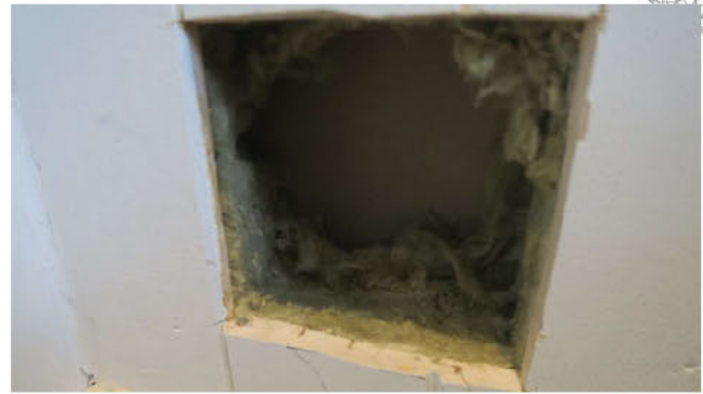
Det er kun trepanel på vegg før isolering og gips på motsatt side. Hvordan himling er utført mot nabo er ikke kjent.
