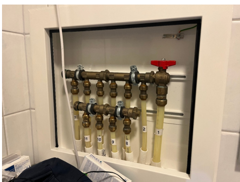
Fordelerskap for vann. Stoppekran funksjonstestet ok.
