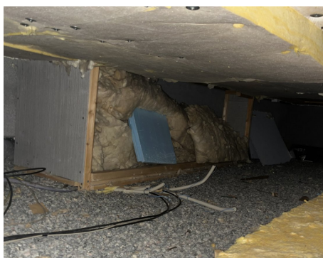
Kryperom under leiligheten med etterisolering av vannrør.
