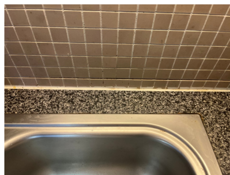
Fliser bør utbedres.
