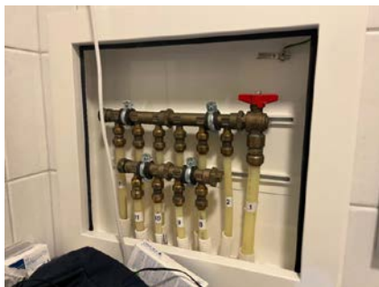
Fordelerskap for vann. Stoppekran funksjonstestet ok.
