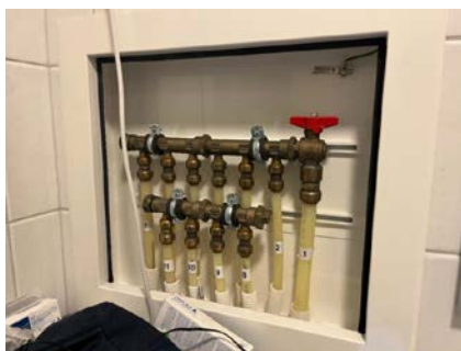
Fordelerskap for vann. Stoppekran funksjonstestet ok.
