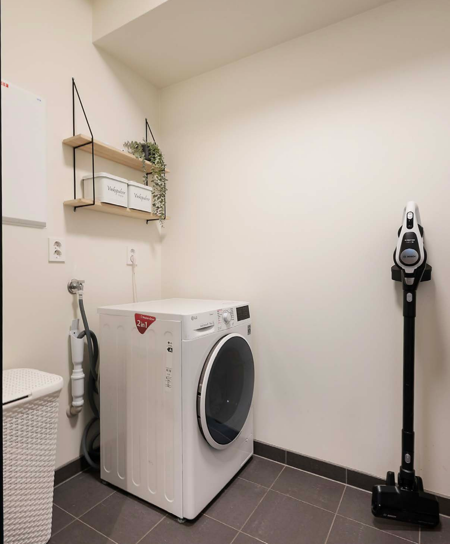
Vaskerom med opplegg for vaskemaskin.
