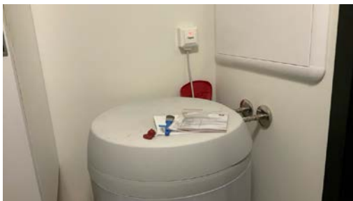
Varmtvannsbereider på 200 L er plassert på teknisk rom i underetasje.
