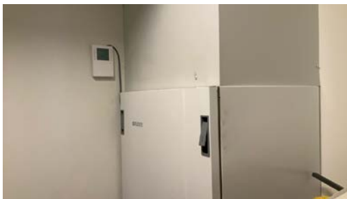
Ventilasjonsaggregat er plassert i teknisk rom i underetasje.
