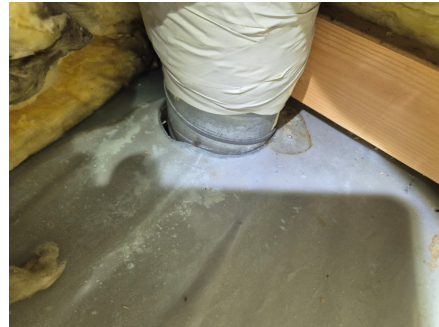
Brudd på dampsperre.
