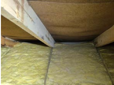
Liten luftespalte i nedre del.
