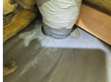
Brudd på dampsperre.
