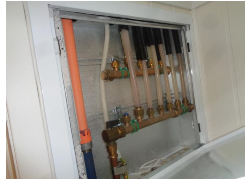
Rør i rør sentral på toalettrom.
