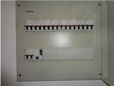
Sikringskap i entrè.
