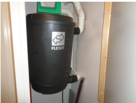
Sentralstøvsuger i toalettrom.
