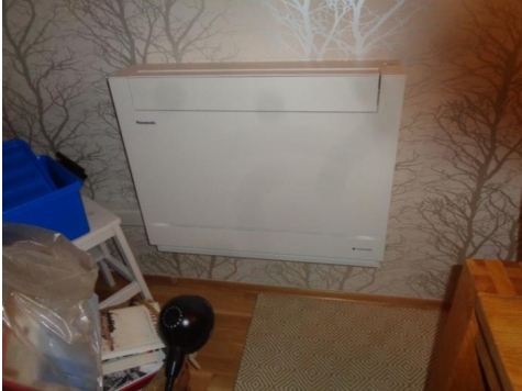
Varmepumpe i stue.
