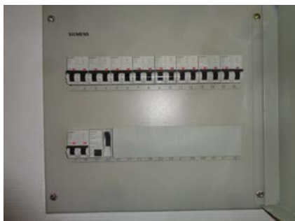
Sikringskap i entrè.
