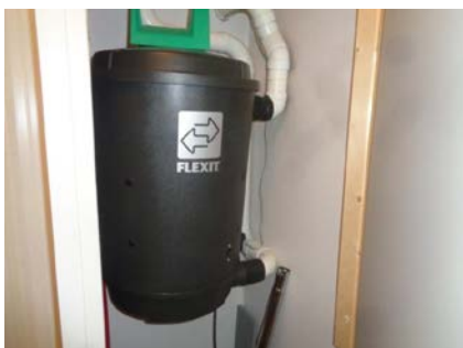
Sentralstøvsuger i toalettrom.
