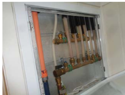
Rør i rør sentral på toalettrom.
