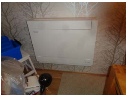
Varmepumpe i stue.
