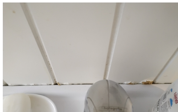
Skader på veggplater bak servant.
