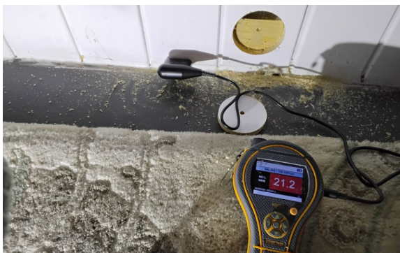
Fuktmåling i trepanelen.
