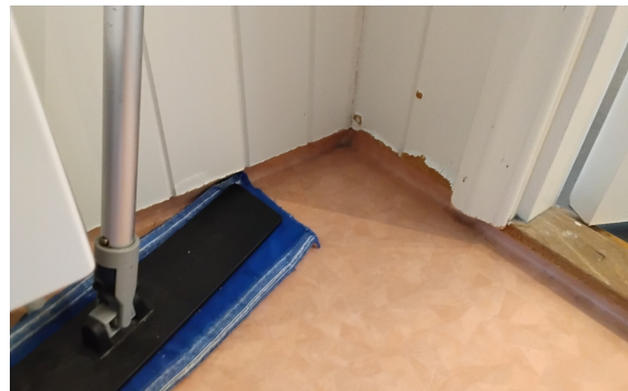
Skader på plater ved innredning.
