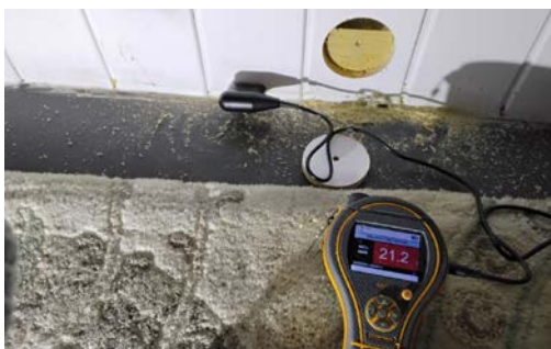
Fuktmåling i trepanelen.
