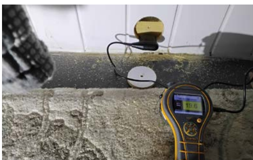
Fuktmåling i trelekt/spikerslag.
