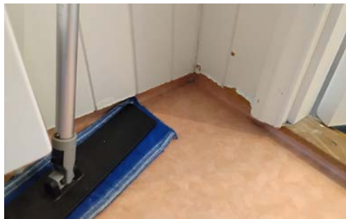
Skader på plater ved innredning.
