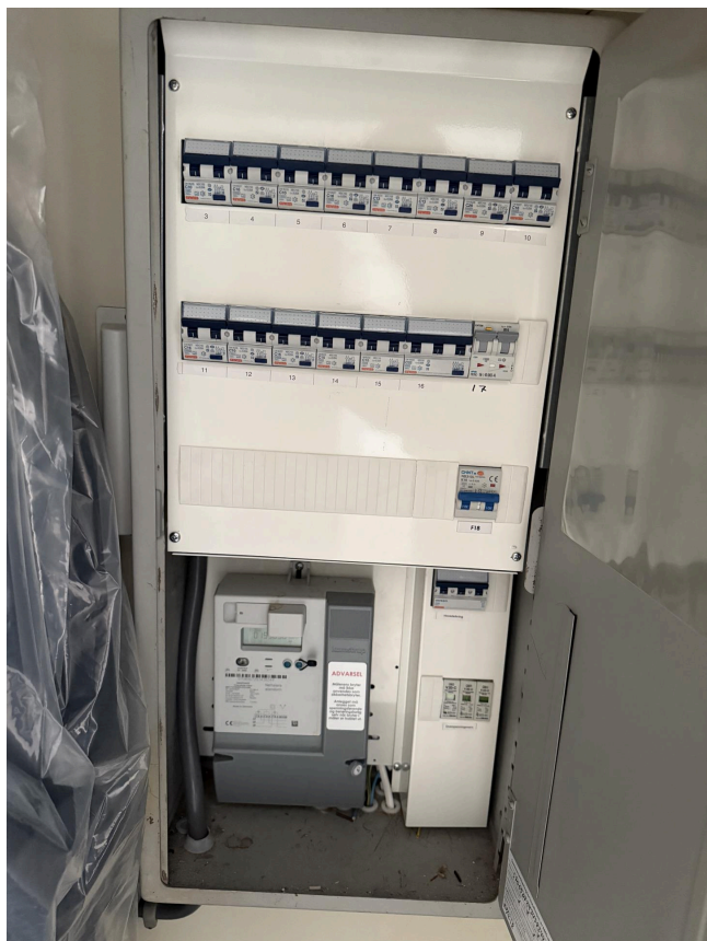
El-skap bolig montert i skap på soverom mot nordøst i 1. etasje, på vegg mot vest.
