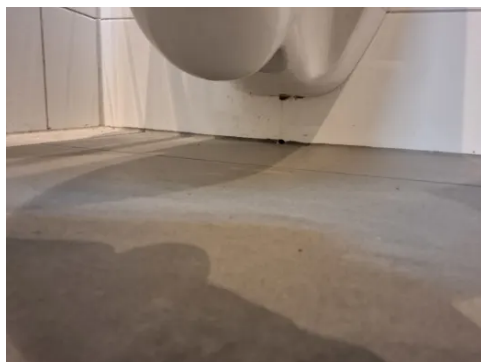
Det er etablert avrenningsmulighet fra innebygde toalettssisterne.
