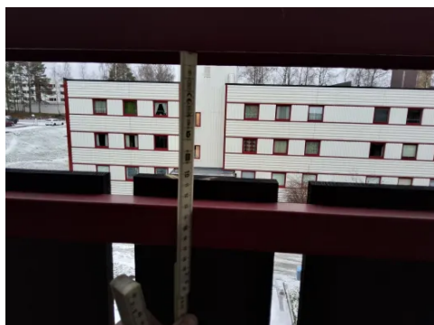
Åpning i rekkverk overstiger 10 cm.
