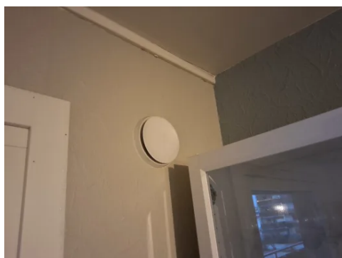
Naturlig tilluft fra ventiler i yttervegg.
