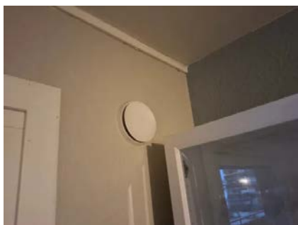
Naturlig tilluft fra ventiler i yttervegg.
