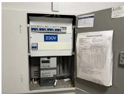
Sikringsskap er plassert i felles trappegang.
