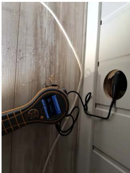
Bilde fra fuktmåling i veggkonstruksjon tilstøtende dusjsjonen.
