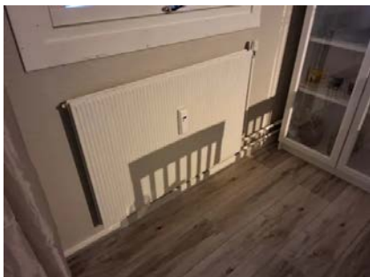
Leiligheten er oppvarmet med vannbåren varme tilknyttet radiatorer.
