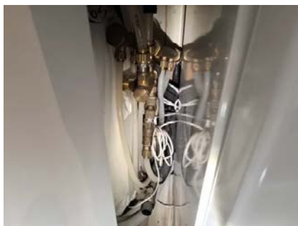
Samlestokker for rør-i-rør, hovedstoppekran og automatisk vannstopper er plassert under kjøkkenbenk.
