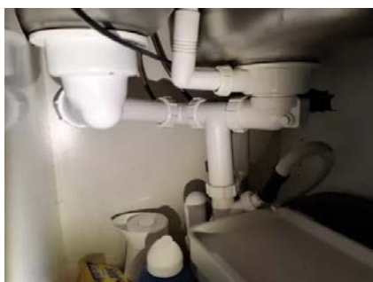
Leiligheten har synlige avløpsrør av plast.
