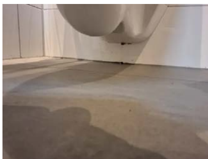
Det er etablert avrenningsmulighet fra innebygd toalettsisterne.
