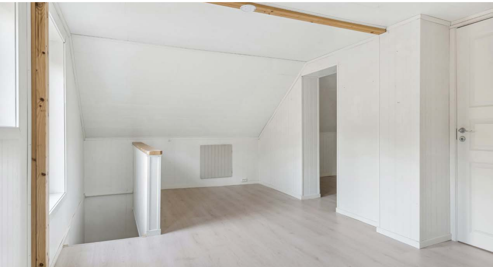
Loftstue. Eldre bolig med skjevheter i gulv og bjelkelag,
