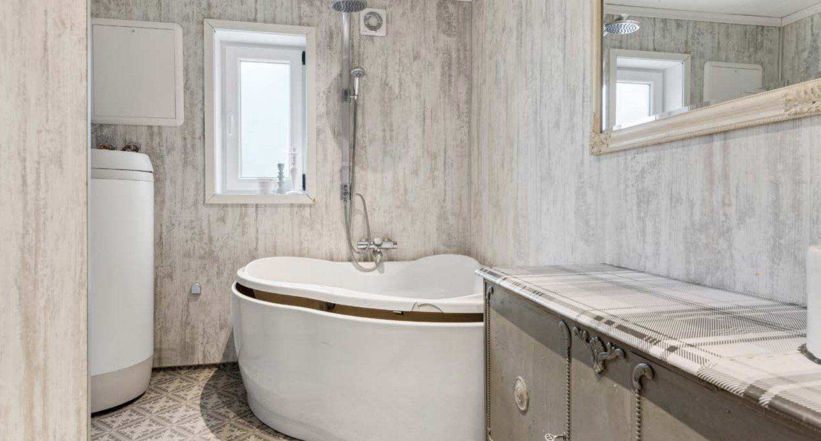
Bad oppgradert i 2016. Belegg på gulv og våtromsplater på vegger. Downlights i malte plater som himling. Panelovn.
