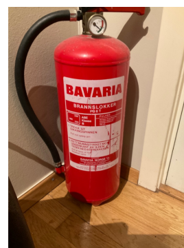
Brannslukningsapparat av ukjent alder.
