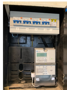
Elskap, plassert i felles trappegang.
