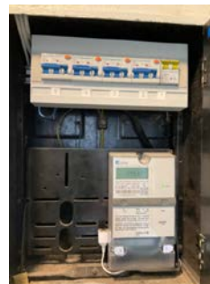
Elskap, plassert i felles trappegang.
