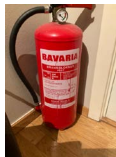
Brannslukningsapparat av ukjent alder.
