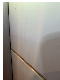
Eksempel på riss i flisene i dusjen.
