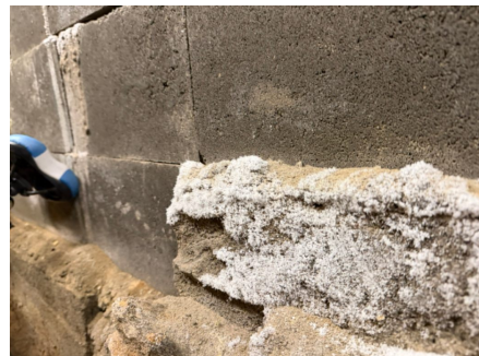
Eksempel på registrert saltutslag på vegg i kjeller.
