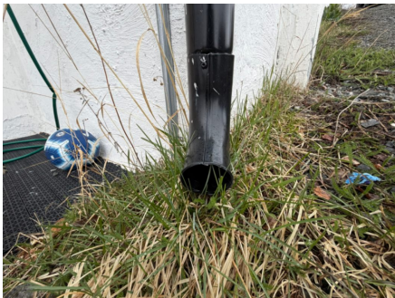
Eksempel på utkast avsluttet over terreng ved grunnmur.
