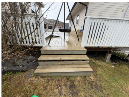
Det er ikke montert rekkverk på trappen.
