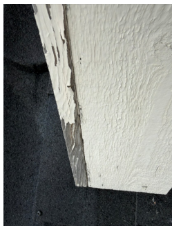
Eksempel på værslitt overflatebehandling.
