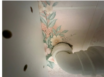
Eksempel på utett rørgjennomføring i våt sone.
