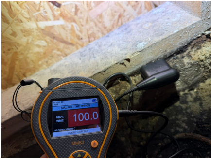
Fuktmåling i svill til innvendig skillevegg.
