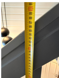
Rekkverkshøyde på innvendig trapp er for liten.
