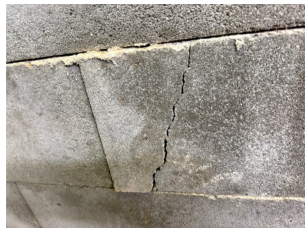
Eksempel på sprekk.
