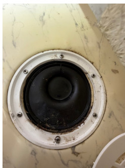
Det er plastsluk plassert under badekaret.
