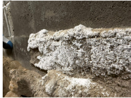
Eksempel på saltutslag.
