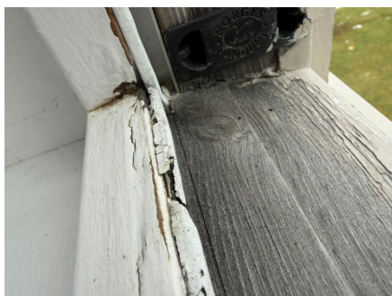
Eksempel på skadet pakninger.
