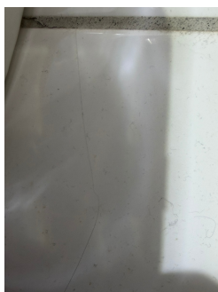
Eksempel på riss i flis ved toalettet.
