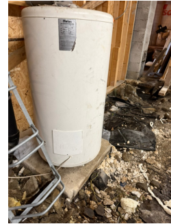
Berederen er plassert i et fuktig miljø.
