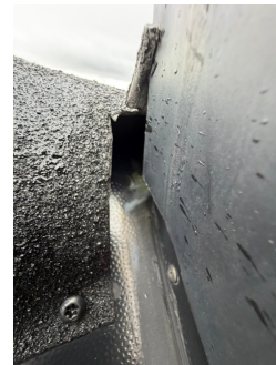
Eksempel på mangelfull tekking av pipen.
