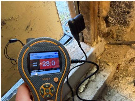
Fuktmåling i karmen til kjellerdøren.
