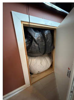
Utstyr hindret tilkomst til kneloftet for inspeksjon.
