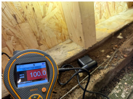
Fuktmålinger på vegg i kjeller. Målingen viser at trefibrene er mettet med vann.
