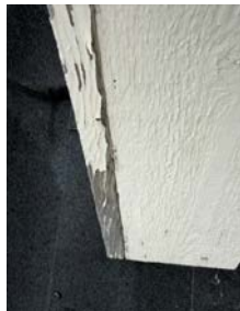
Eksempel på værslitt overflatebehandling.
