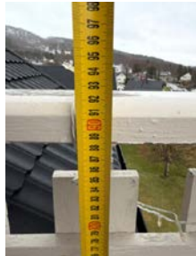
Rekkverkshøyder på altanene er for lav iht dagens krav.
