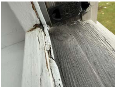
Eksempel på skadet pakninger.
