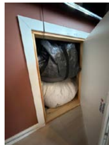
Utstyr hindret tilkomst til kneloftet for inspeksjon.
