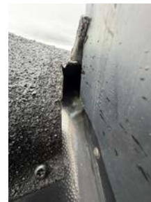
Eksempel på mangelfull tekking av pipen.
