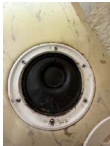
Det er plastsluk plassert under badekaret.
