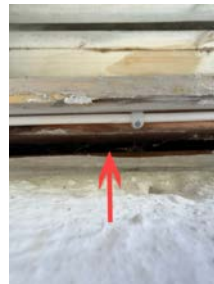
Eksempel på hvor det ikke er etablert gnagersperre.
