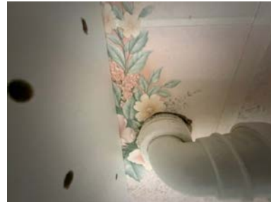
Eksempel på utett rørgjennomføring i våt sone.
