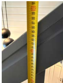
Rekkverkshøyde på innvendig trapp er for liten.
