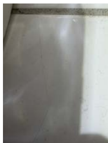
Eksempel på riss i flis ved toalettet.
