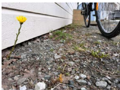
Eksempel på kledning med for liten avstand til terreng.
