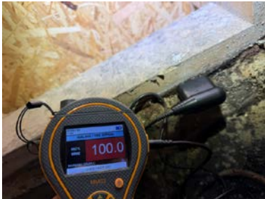
Fuktmåling i svill til invendig skillevegg.
