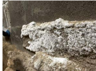
Eksempel på saltutslag.
