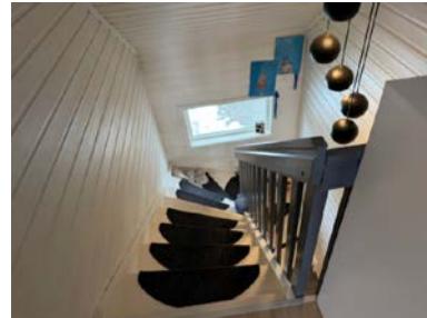
Det mangler håndløper i trappeløpet.
