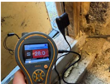
Fuktmåling i karmen til kjellerdøren.
