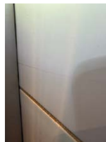
Eksempel på riss i flisene i dusjen.
