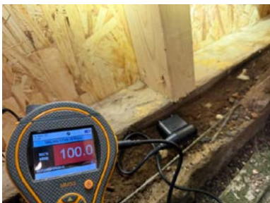
Fuktmålinger på vegg i kjeller. Målingen viser at trefibrene er mettet med vann.
