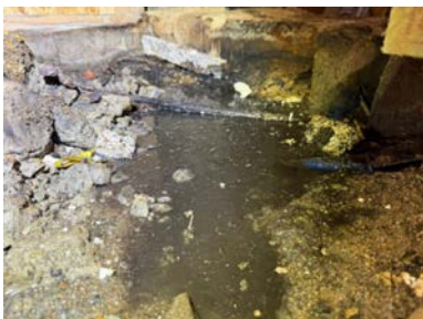
Eksempel på vann i kjeller.
