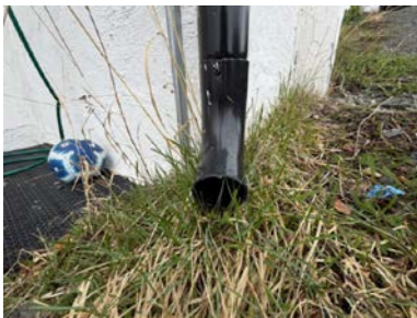
Eksempel på utkast avsluttet over terreng ved grunnmur.
