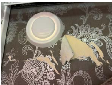
Eksempel på skadet tapet.
