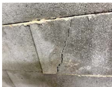
Eksempel på sprekk.
