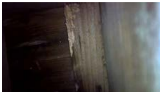
Gnag på treverk i konstruksjon etter rotte filmet med inspeksjonskamera.
