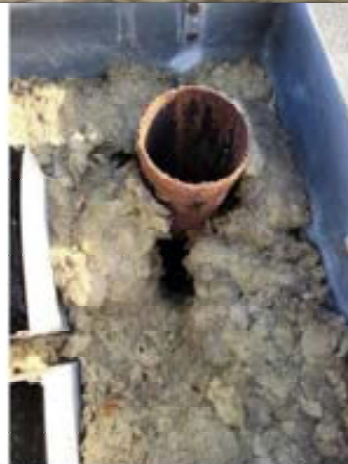
Rotter har tatt seg opp av lufting over tak på soilrør og tatt seg ned i isolasjon i konstruksjon.
