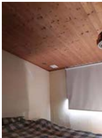
Luke montert i tak på soverom i andre etasje. Tidligere fangst av voksen rotte.
