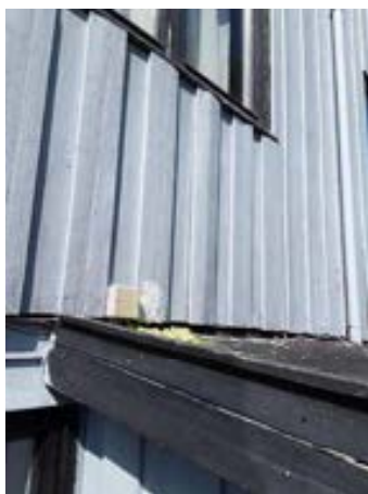
Isolasjon fra vegg. Hull er tettet. Rotter har gnagd seg ut av kledning.
