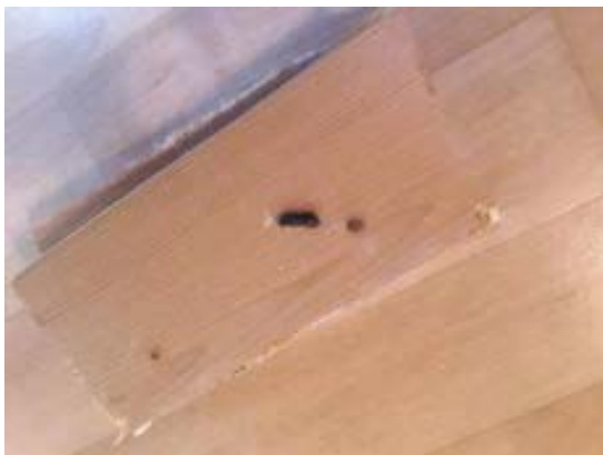
Avføring fra rotter funnet i konstruksjon.
