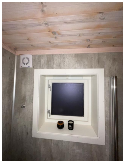
Mekanisk avtrekk på vegg og åpningsvindu med ventil
