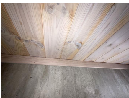
Silikon rester og ujevn overflate i himling
