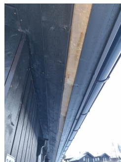
Synlig luftespalte i raftekasse ved overgang tak/vegg
