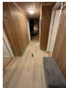
1. etasje Plassering av laser ved kontroll av gang. Det er målt 5 mm høydeforskjell gjennom rommet. TG 1
