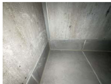
Mangler tilstrekkelig med mykfuge ved overgang veggflis mot sokkellist våtromspanel i våtsone
