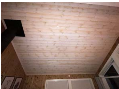
Ujevn overflatebehandling på panel, bildet viser panel i himling på stue
