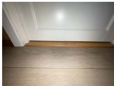
Luftespalte under dør
