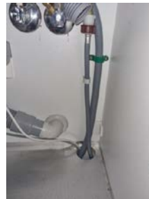
Bilde fra kjøkkenskap som viser at det ikke er montert vannføler i henhold til tekniske krav.
