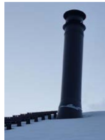
Rester etter tape på nedre del av pipe.
