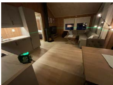
1. etasje Plassering av laser ved kontroll av stue/kjøkken. Det er målt 9 mm høydeforskjell gjennom rommet. TG 1
