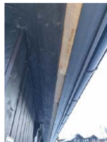
Synlig luftespalte i raftekasse ved overgang tak/vegg
