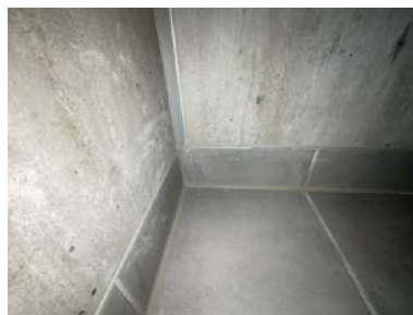
Mangler tilstrekkelig med mykfuge ved overgang veggflis mot sokkellist våtromspanel i våtsone
