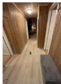
1. etasje Plassering av laser ved kontroll av gang. Det er målt 5 mm høydeforskjell gjennom rommet. TG 1
